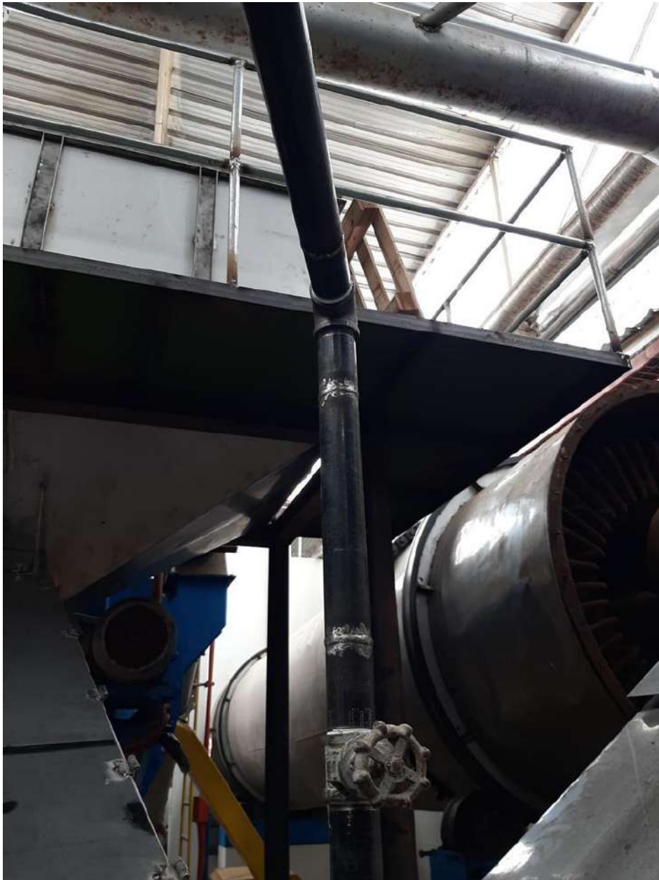
Figura 3. Equipos de la línea de dosificación del concentrado de harina de pescado.
