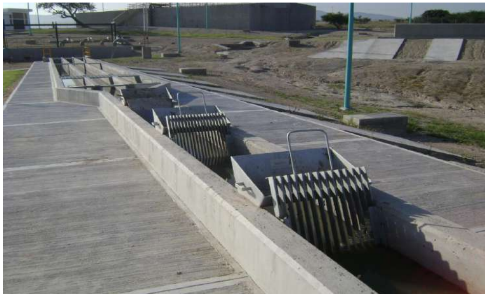
Figura 2 Pretratamiento de aguas residuales
