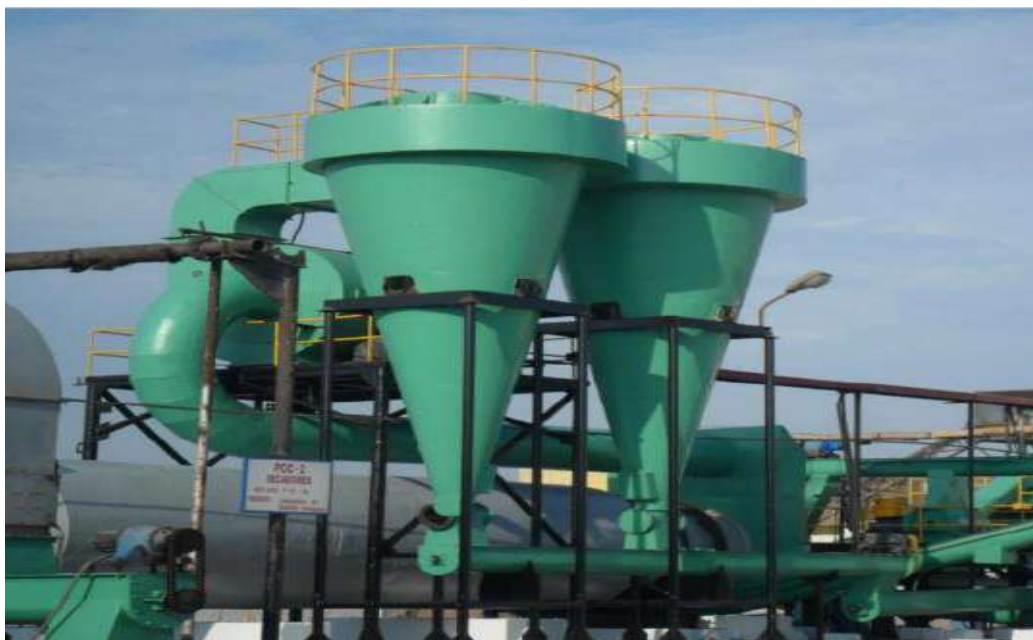
Figura 3.- Ciclones del enfriador
