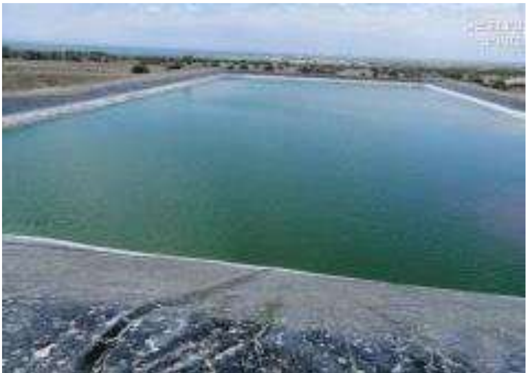
Figura 27. Planta de Tratamiento de Aguas Residuales Puerto Rico, se evidenció poza de oxidación con agua residual, no cuentan con personal para verificar la operatividad de las pozas.
