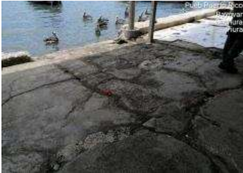
Figura 22. Plataforma Puerto Rico 7 en mal estado de conservación. Cuenta con piso de cemento deteriorado y piso de mayólica deteriorado.
