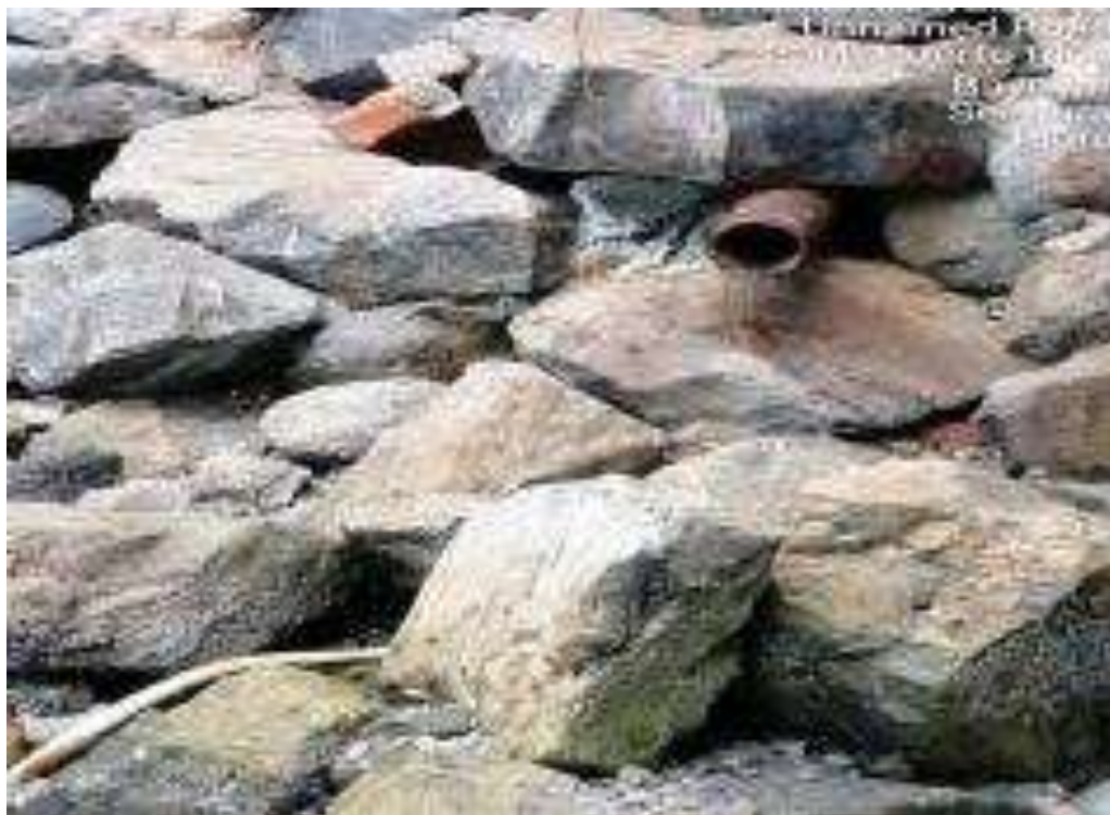
Figura 23. Plataforma Puerto Rico 12 en la que se comercializa combustible, se evidencia tubería de evacuación de efluentes al mar.
