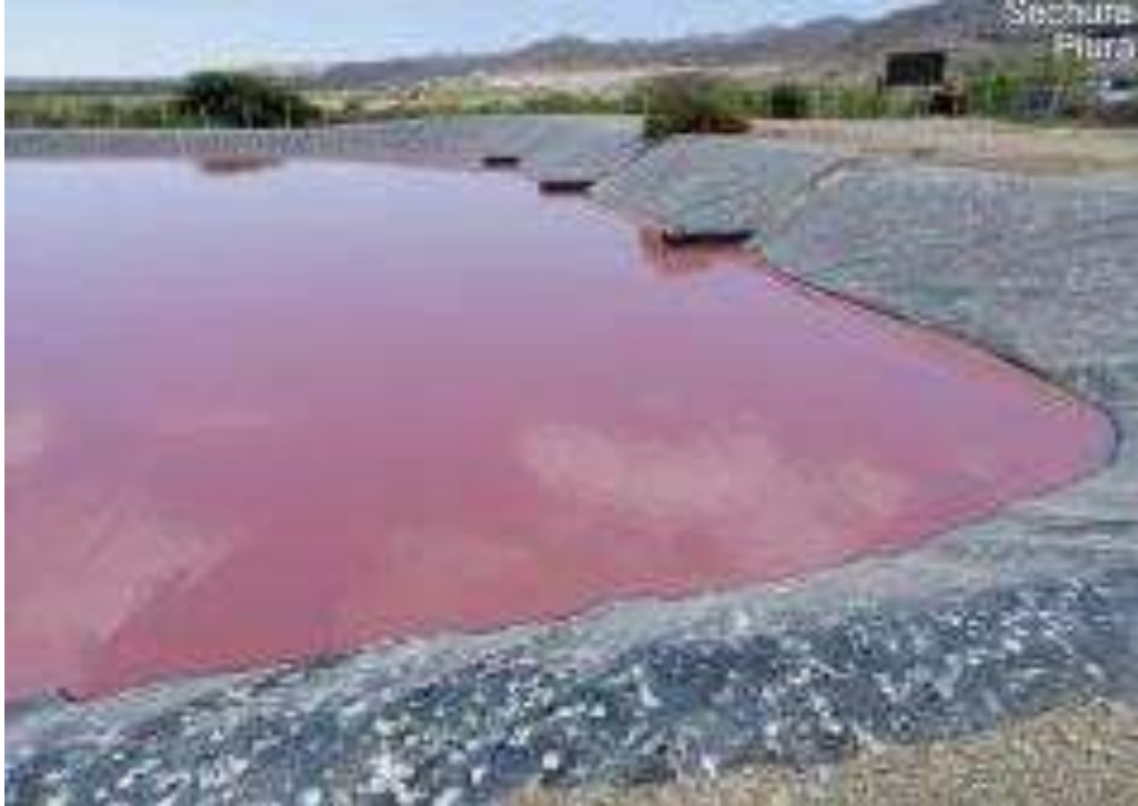
Figura 26. Planta de Tratamiento de Aguas Residuales Puerto Rico. Se evidenció 03 pozas de oxidación con agua residual, no cuentan con personal para verificar la operatividad de las pozas
