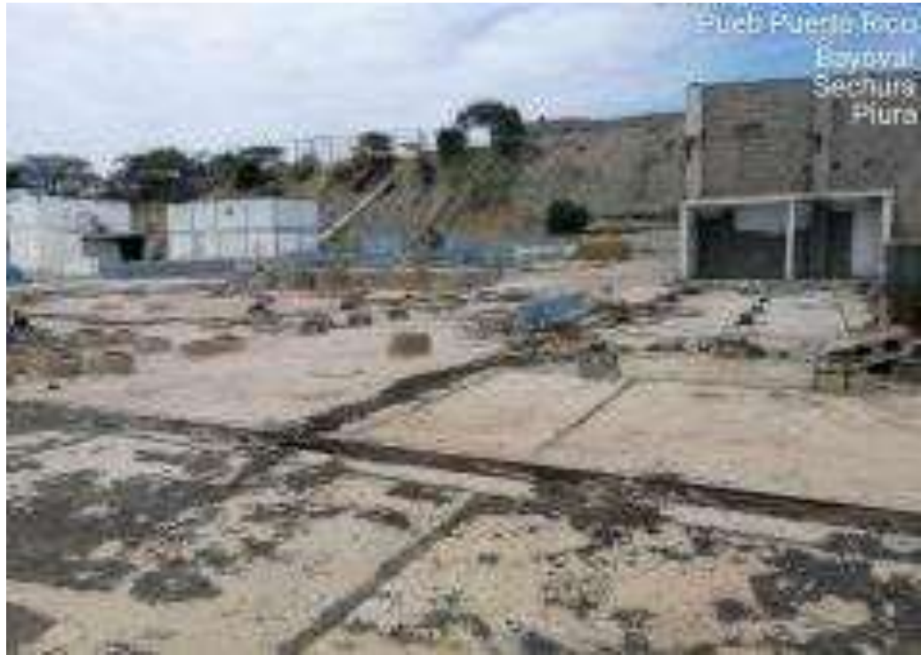
Figura 20. Pesquera Diamante, infraestructura abandonada, se evidencian tuberías inoperativas.
