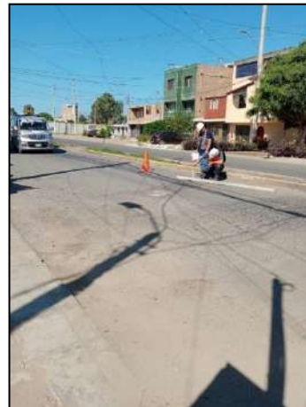
Fotografía 3: Identificación de peladura por intemperismo y desprendimiento de agregados
