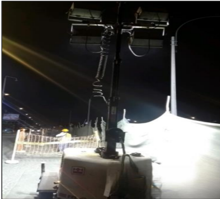
Figura 21. Torre de iluminación
