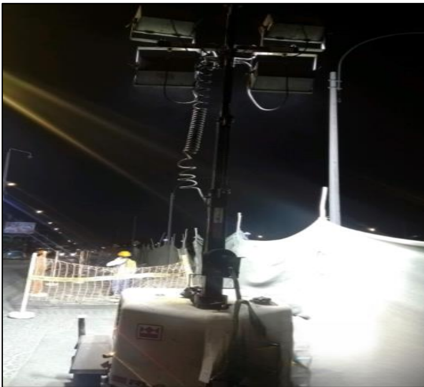
Figura 21. Torre de iluminación
