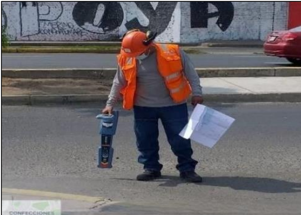
Figura 27. Detección de interferencias eléctricas.
