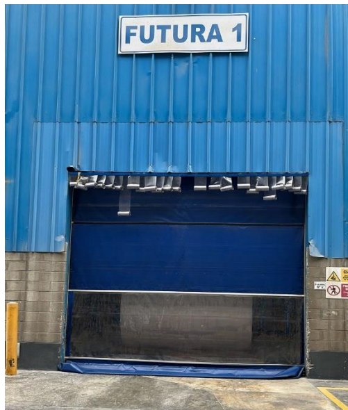
Figura 9: Puerta rápida atascada al momento de elevarse, planta Kimberly Clark sede Puente Piedra
