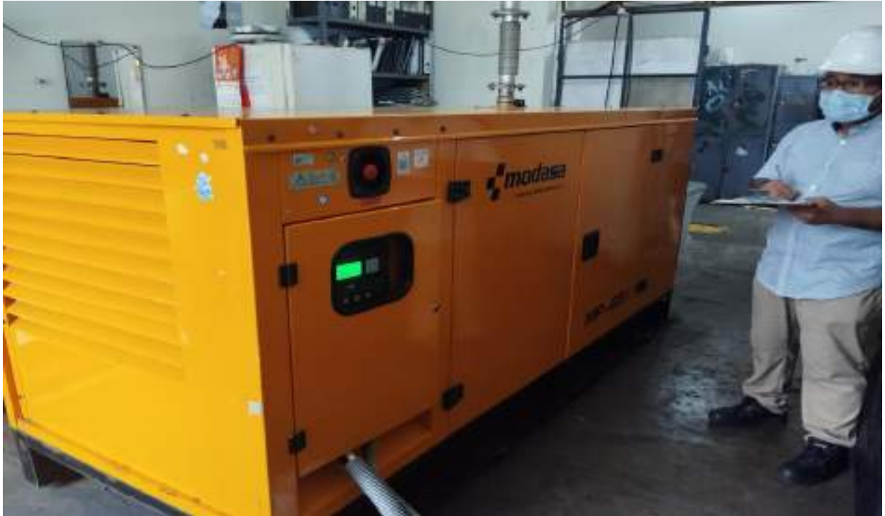
Figura 30 Emisión directa por consumo de combustible -Grupo electrógeno
