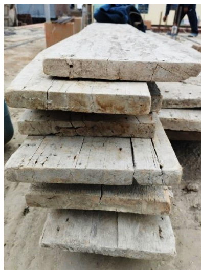
Figura 22 Tablones en mal estado usados en el encofrado de la vivienda N° 01
