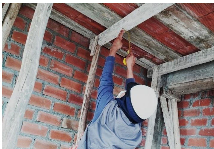
Figura 27 Medición de la sección transversal de las soleras en la vivienda N° 02
