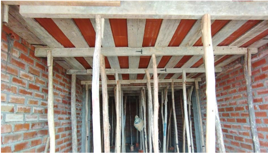
Figura 57 Separación de los tablonos en el encofrado de la vivienda N° 05
