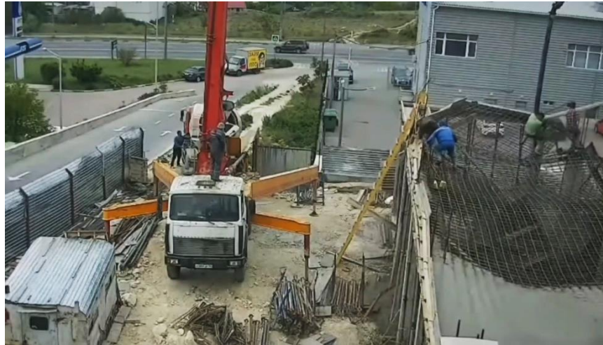
Figura 1 Falla estructural del encofrado para una losa maciza
