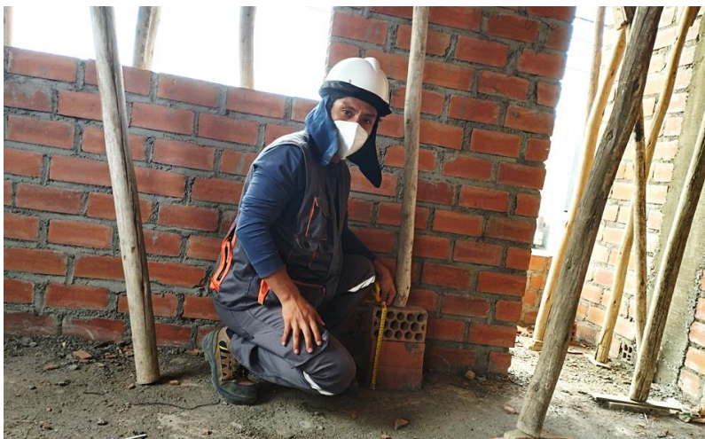
Figura 30 Medición de la altura de la cuña del pie derecho en la vivienda N° 02
