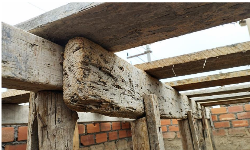
Figura 83 Solera en pésimas condiciones en el encofrado de la vivienda N° 07
