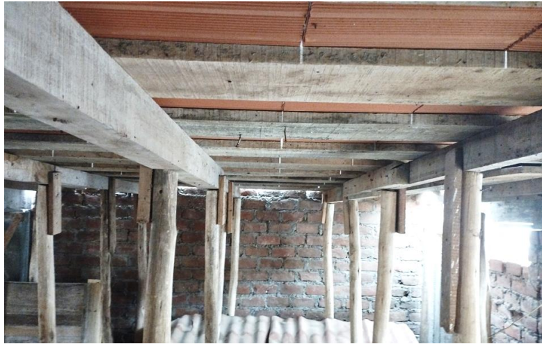
Figura 70 Separación de soleras en el encofrado de la vivienda N° 06
