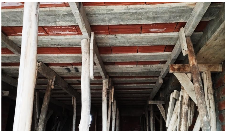
Figura 25 Separación de tablonos en el encofrado de la vivienda N° 02
