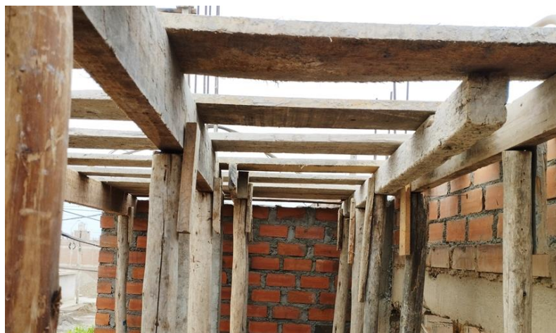
Figura 77 Separación de los tablonés en el encofrado de la vivienda N° 07
