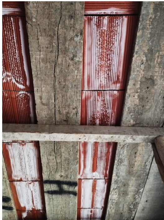
Figura 33 Tablones dañados utilizados en el encofrado de la vivienda N° 02
