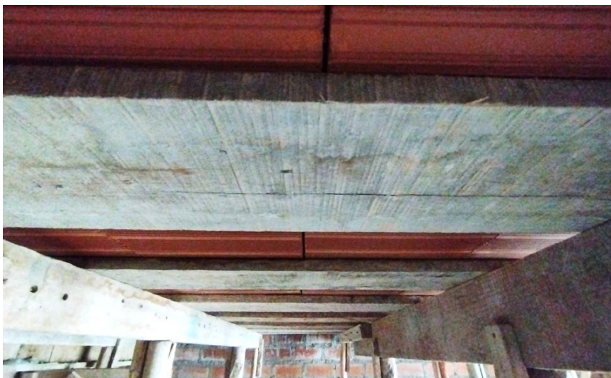
Figura 64 Tablón agrietado utilizado en el encofrado de la vivienda N° 05
