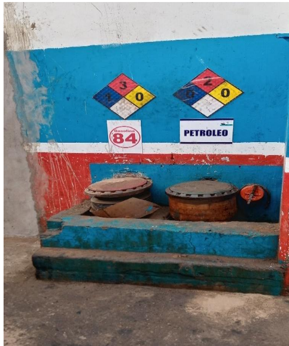
figura 51 Almacenamiento de combustible
