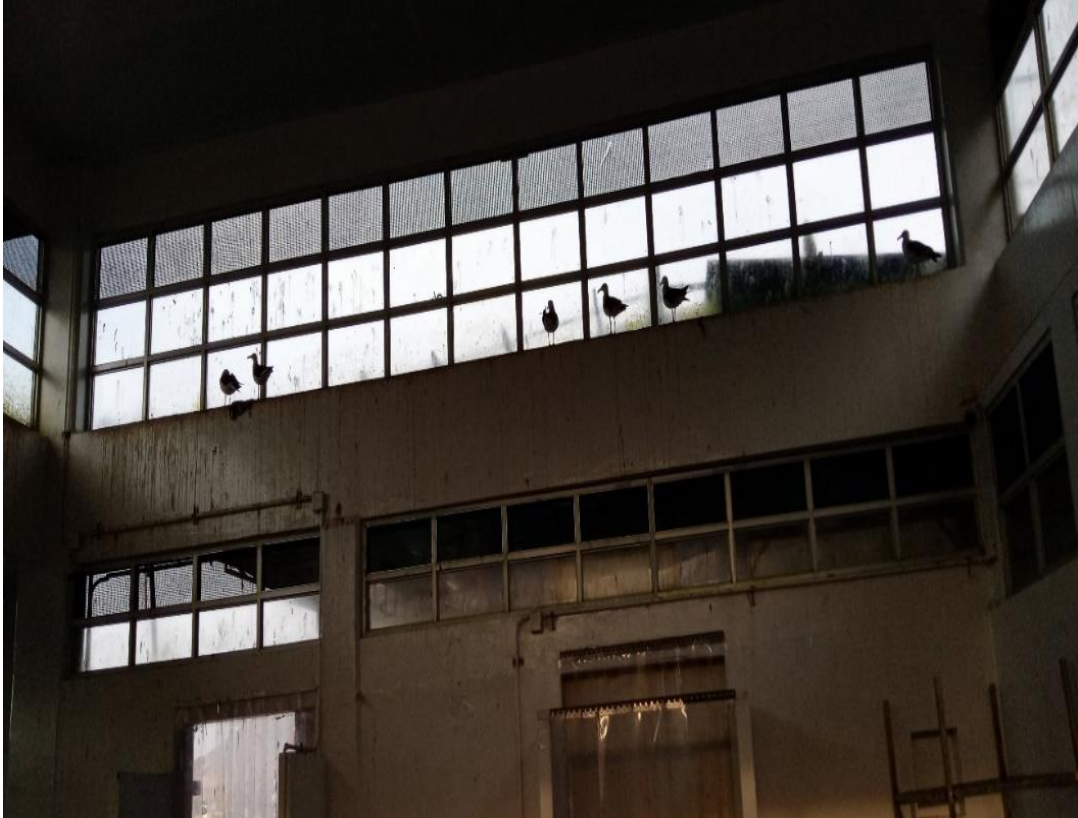
figura 27 Paredes con heces de aves
