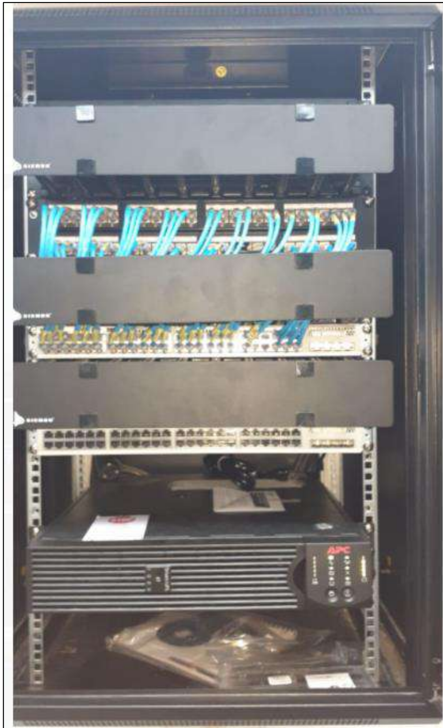
Figura 25:Gabinete con Dispositivos de Red
