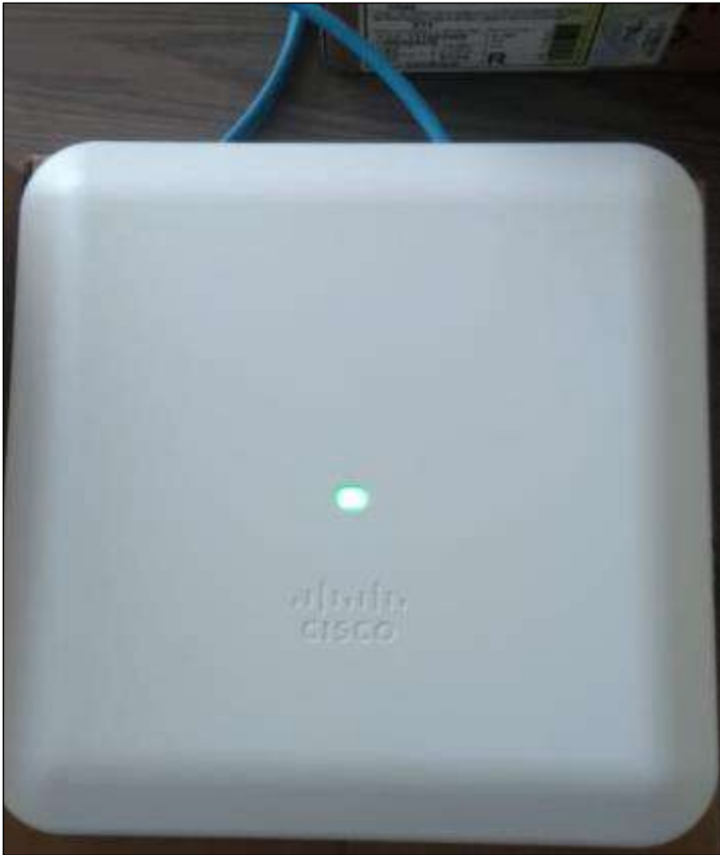
Figura 24:Access Point Implementado en la FIISI
