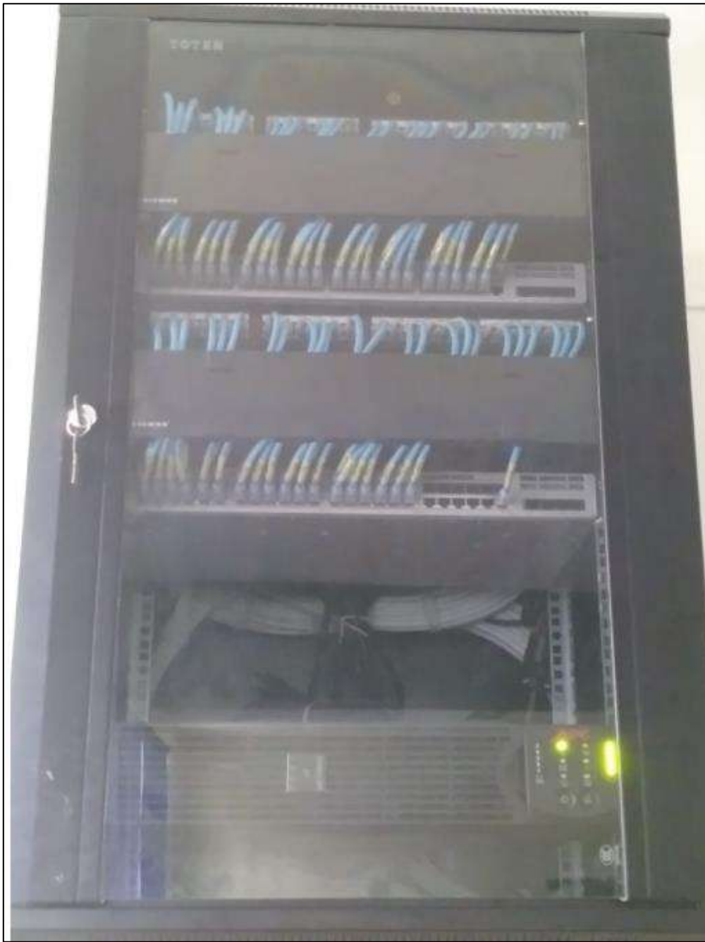
Figura 26:Gabinete con Dispositivos de Red Trabajando
