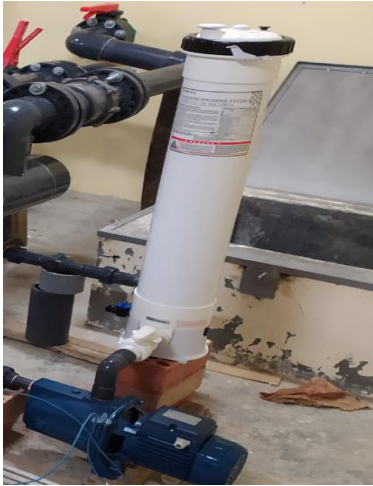
Figura 23. Clorinador y bomba de inyección de cloro.
