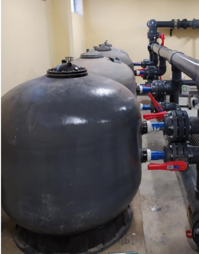
Figura 16. Filtro de arena.
