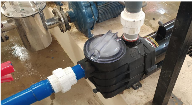
Figura 22. Bomba de aspirado con trampa de pelos.
