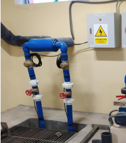
Figura 21. Tablero de control para bombas sumergibles.
