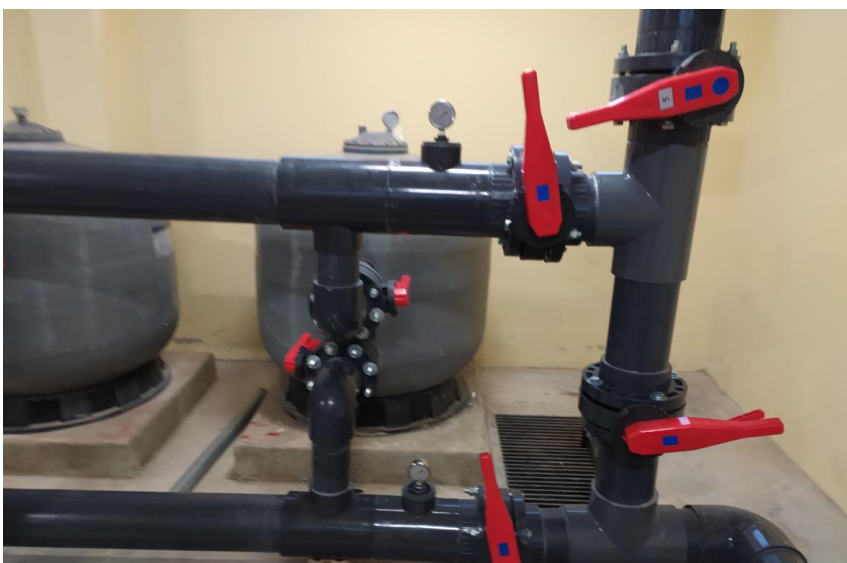
Figura 18. Válvulas de control.
