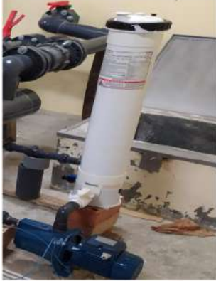
Figura 23. Clorinador y bomba de inyección de cloro.
