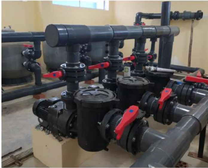
Figura 17. Electrobombas para piscina de polipropileno reforzado.
