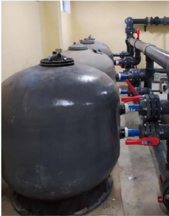
Figura 16. Filtro de arena.
