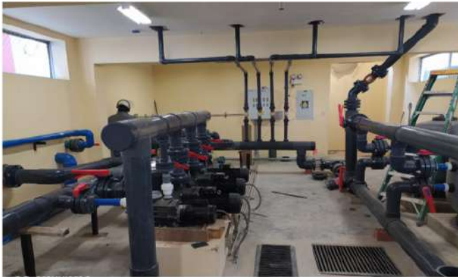
Figura 19. Tuberías de recirculación entre los diferentes equipos del sistema.
