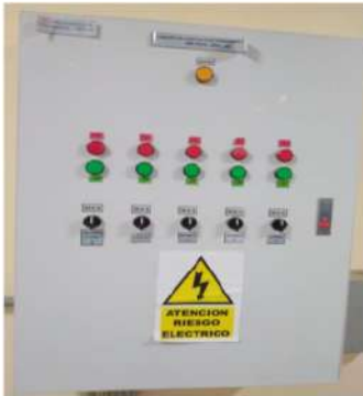
Figura 25. Tablero de control manual de electrobombas de piscina.
