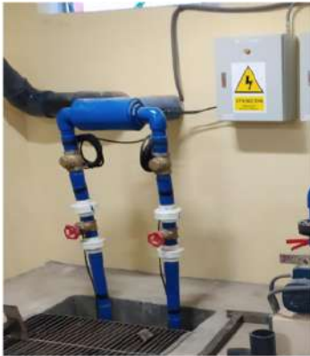
Figura 21. Tablero de control para bombas sumergibles.
