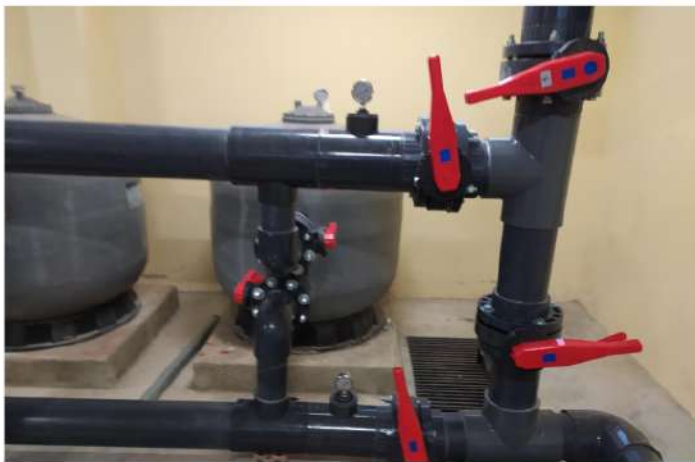
Figura 18. Válvulas de control.
