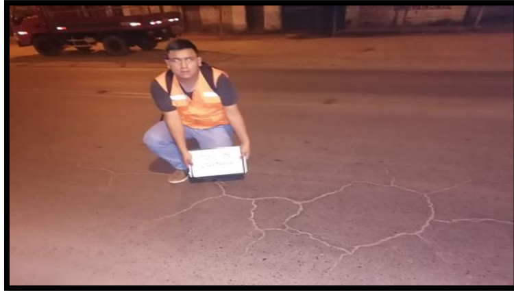
Imagen 20: Falla de piel de cocodrilo
