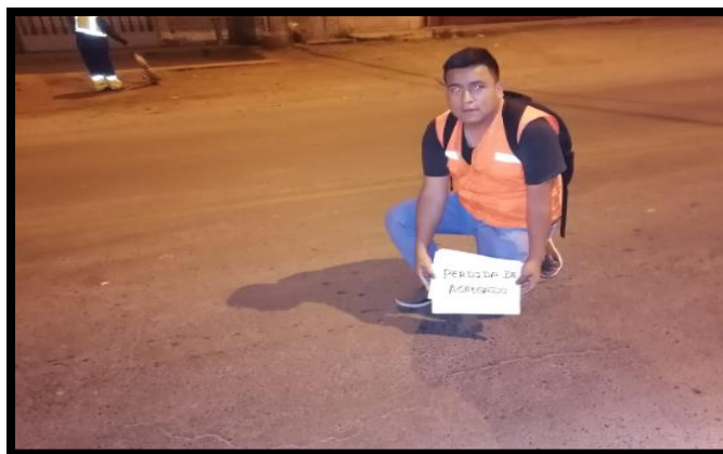
Imagen 19: Falla perdida de agregado
