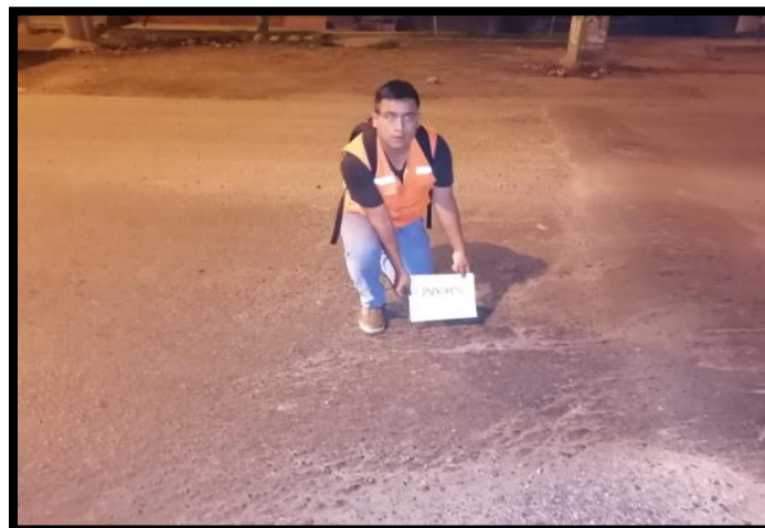
Imagen 22: Falla perdida de agregado
