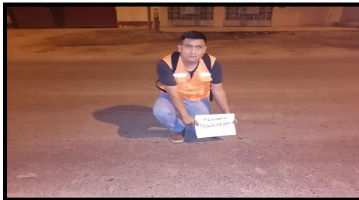
Imagen 18: Falla de fisura transversal
