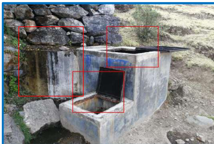
Figura 14: Se observa corrosión y oxido en las tapas metálicas de la captación existente
