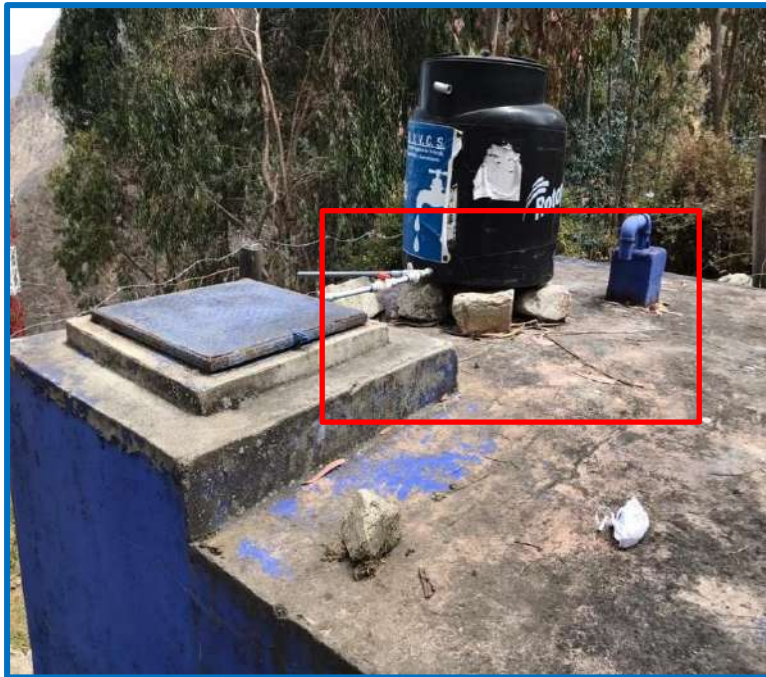
Figura 10: Reservorio existente con su cisterna de cloración
