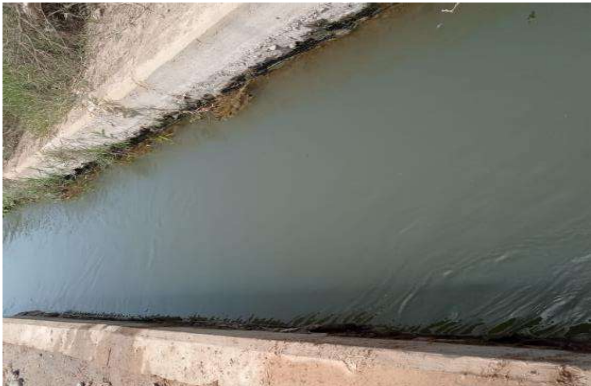
Figura 18. Apreciación física de la calidad de agua canalizada hacia Carquín Chico.
