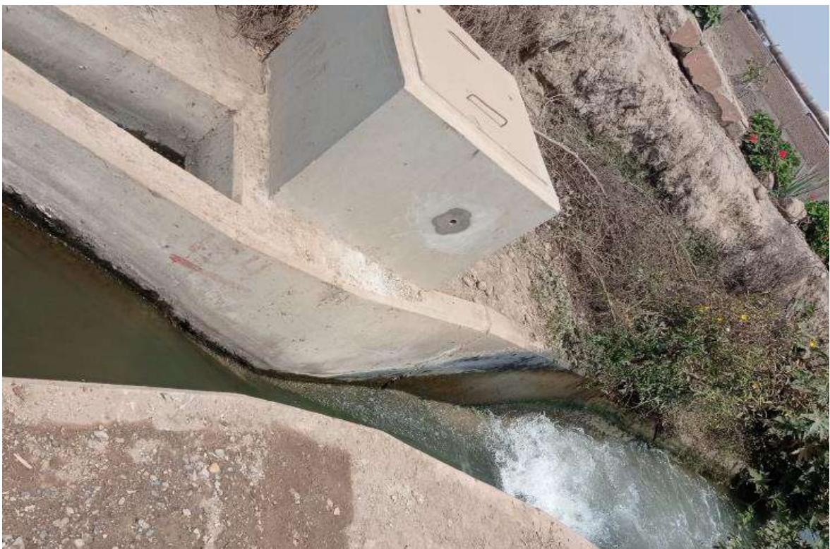
Figura 20. Medidor de Caudal de agua de abastecimiento hacia Carquín Chico.
