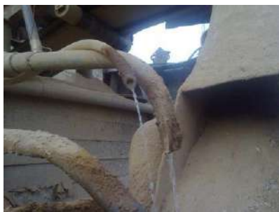
Figura N° 3: alimentación de cianuro de sodio.
