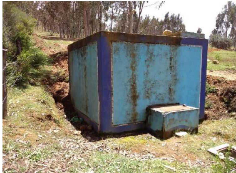
Figura 3. Depósito de tratamiento (clorados) de agua potabilizada
