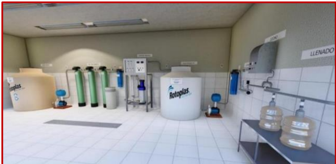
Figura Nro. 15. Características de la Implementación física del sistema de purificación de agua por ozono en la Facultad de Ingeniería Química y Metalúrgica.
