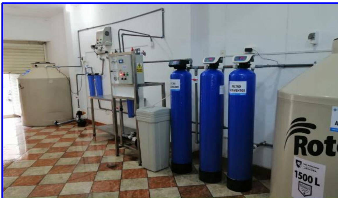
Figura Nro. 14. Características físicas de la Implementación del sistema de purificación de agua por ozono en la Facultad de Ingeniería Química y Metalúrgica.
