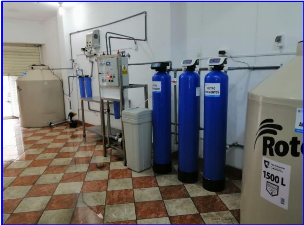
Figura Nro. 01. Acondicionamiento, distribución de equipos, sistema de osmosis, y ozonización.
