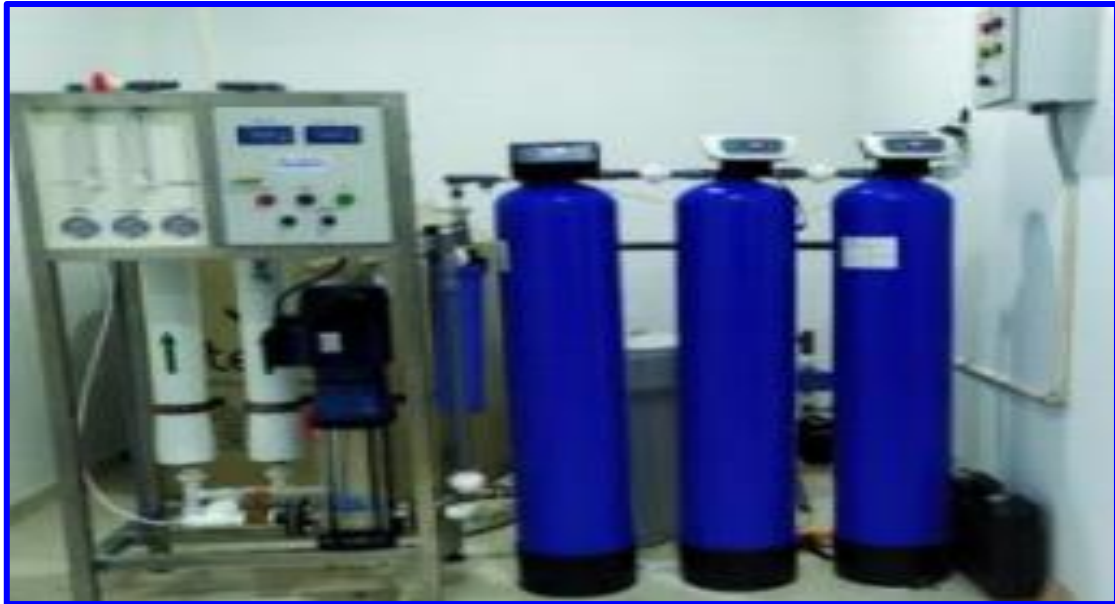
Figura. Nro. 12. Equipo de Osmosis inversa.
