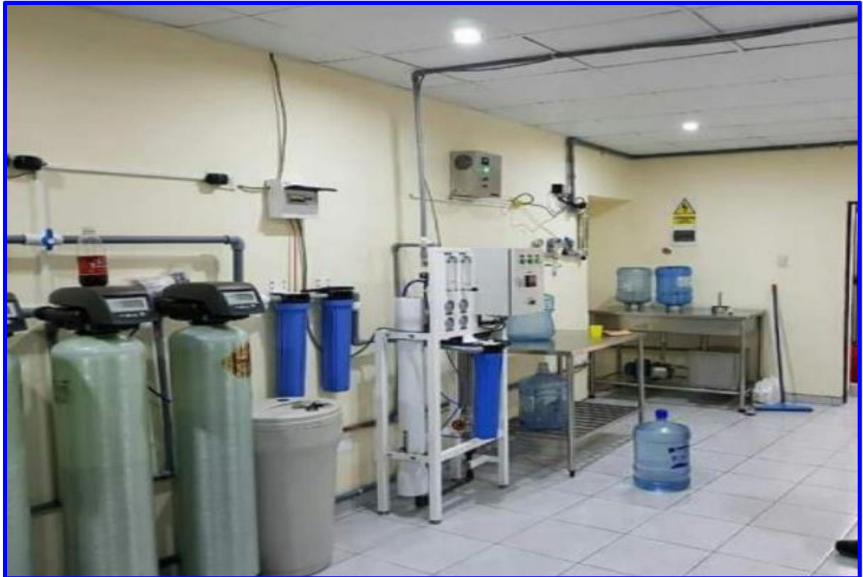
Figura Nro. 03. Acondicionamiento, distribución de equipos, sistema de osmosis, y ozonización.
