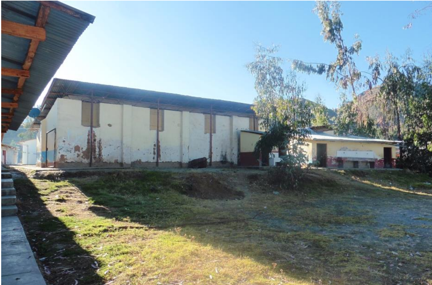
Fotografía 4 Situación Actual de las aulas en estado deteriorado actual
