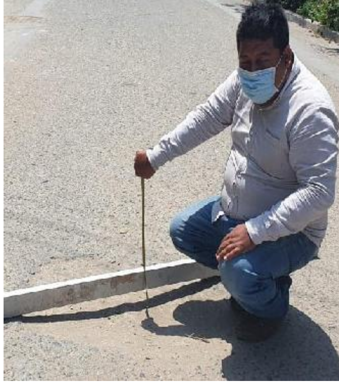
Figura 2. Ubicación de falla por deformación (Fuente: propia)
