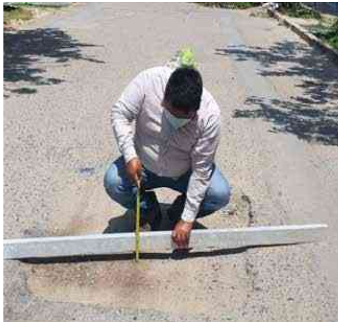
Figura 3. Localización de falla por deformación (Fuente: propia)
