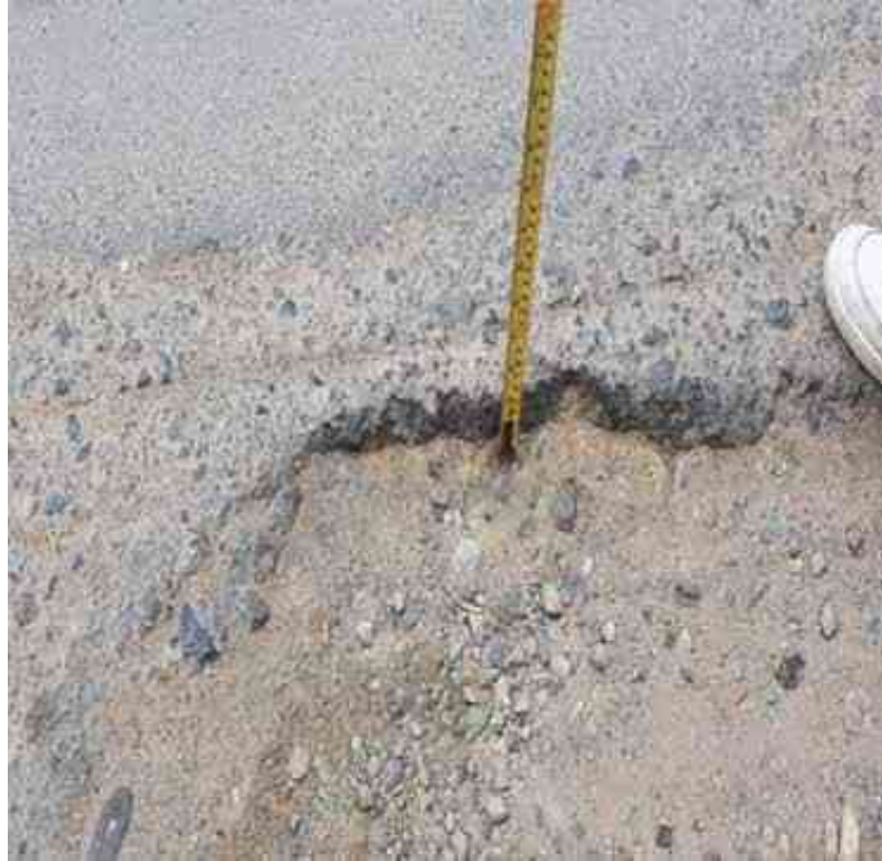
Figura 4. Detección de falla por deformación (Fuente: propia)
