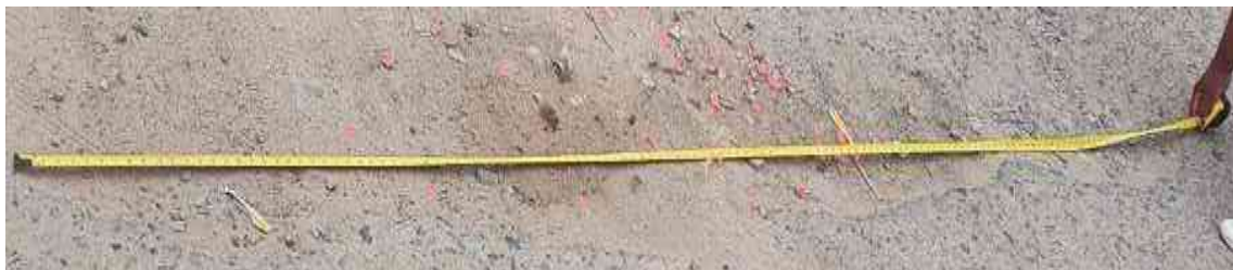
Figura 7. Localización de falla por fisura transversal (Fuente: propia)
