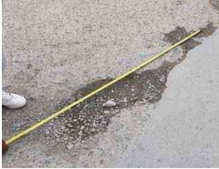
Figura 8. Ubicación de falla por fisura long. (Fuente: propia)
