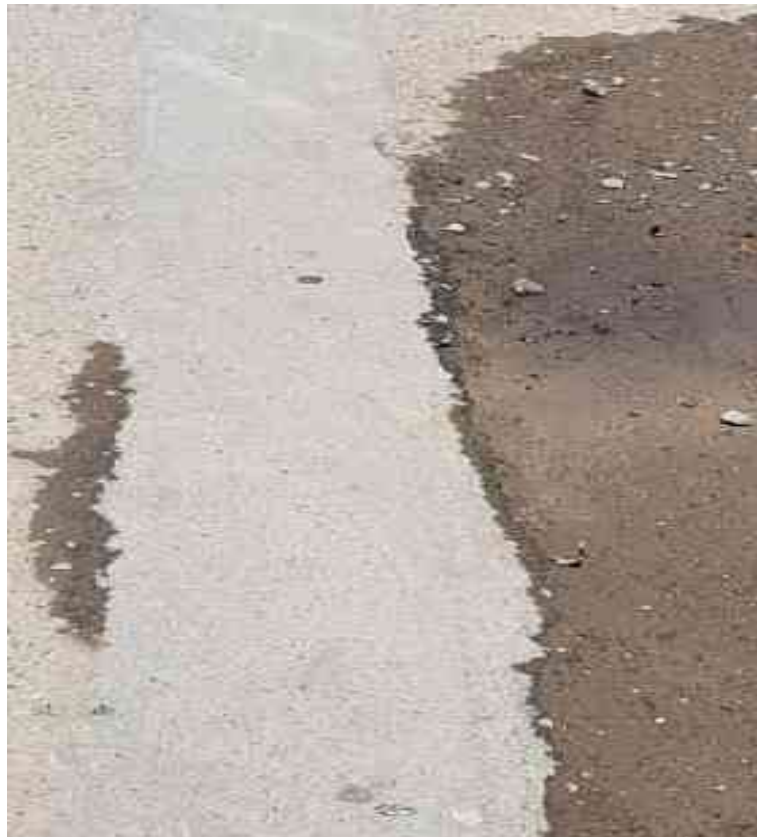
Figura 9. Detección de falla por fisura longitudinal (Fuente: propia)
