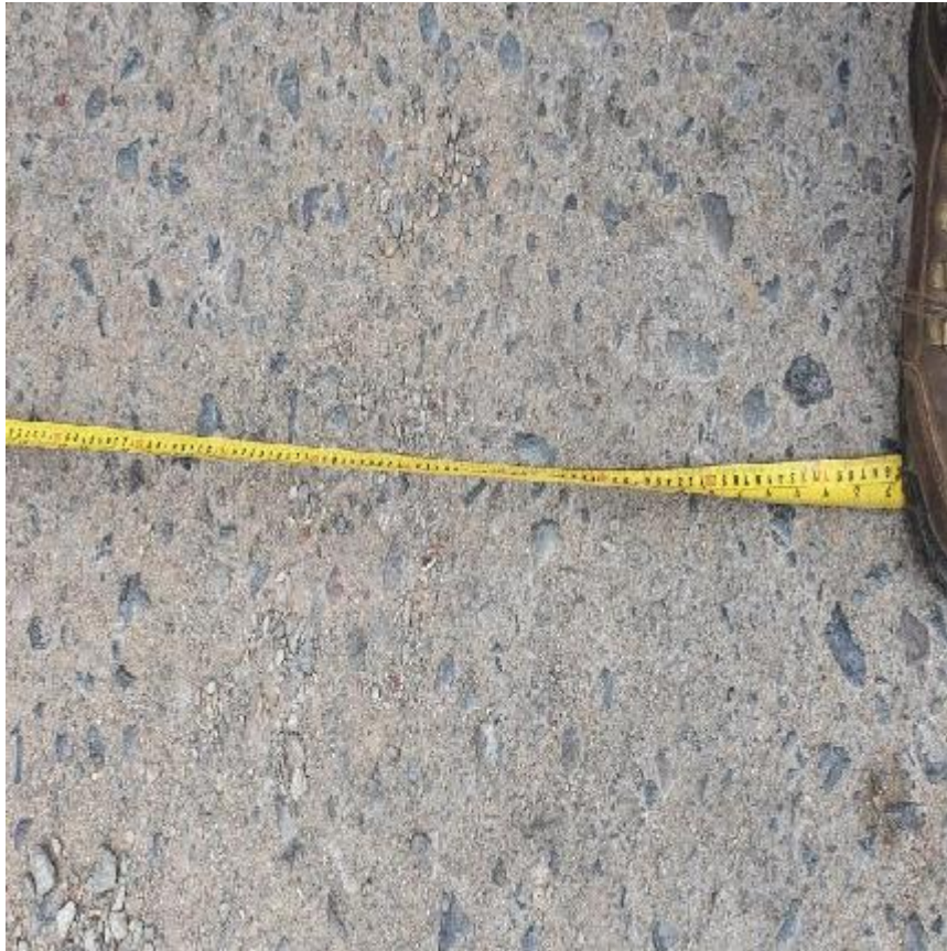
Figura 6. Localización de falla por ondulaciones (Fuente: propia)
