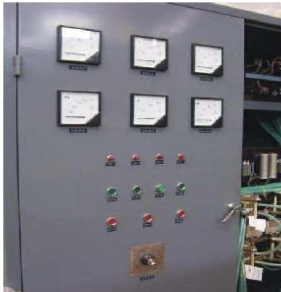
FIG 3.4 VISTA INTERIOR DEL TABLERO DE CONTROL ELECTRÓNICO Y FUERZA
