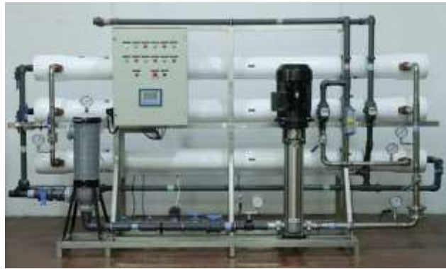
Figura N° 06: Equipo de osmosis inversa
