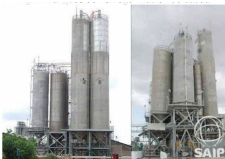
Fig. 7. Tanques de homogenización de caudal
