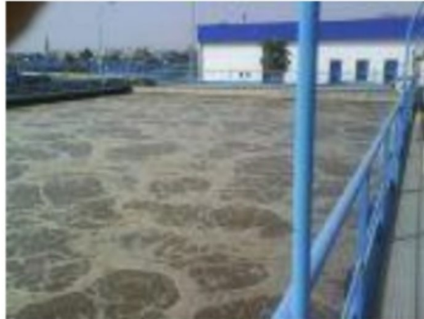
Fig. 11. Piscina de aireación
