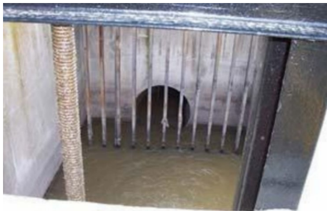
Fig. 6. Rejilla de retención de sólidos gruesos
