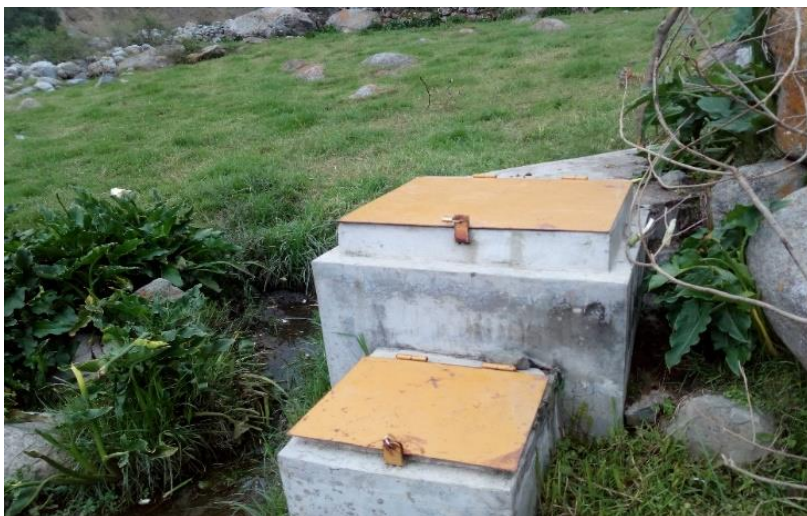
Figura 18. Vista del Estado Estructural de la Captación Existente.
