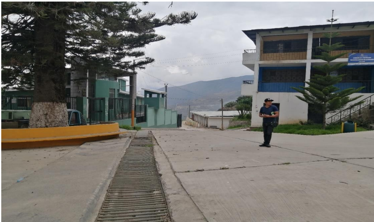
Figura 23. Canaleta se ubica en la intersección de la calle San Martín y comercio, estas son descargadas en una quebrada ubicada en la entrada que luego termina al río Ámbar.
