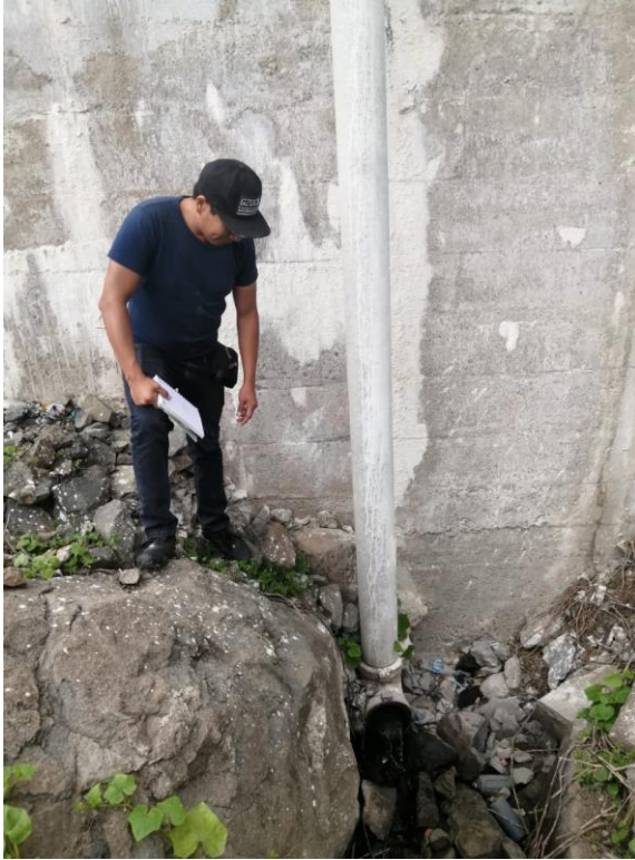
Figura 42. Vista de Salida de Ventilación del Tanque Imhoff, el cual contiene un Caudal Mínimo de Salida.
