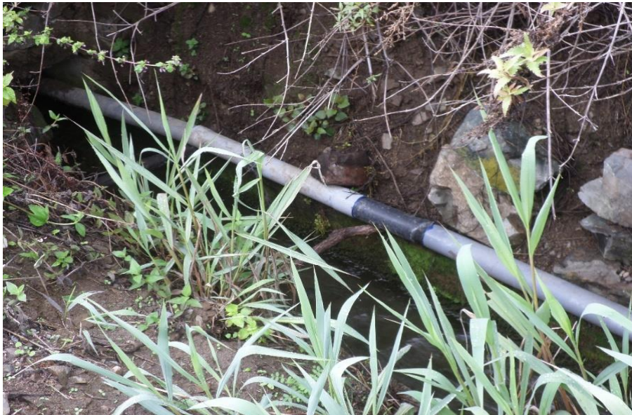
Figura 19. Vista de la Línea de Conducción Descubierta y Expuestas a Posibles Daños.
