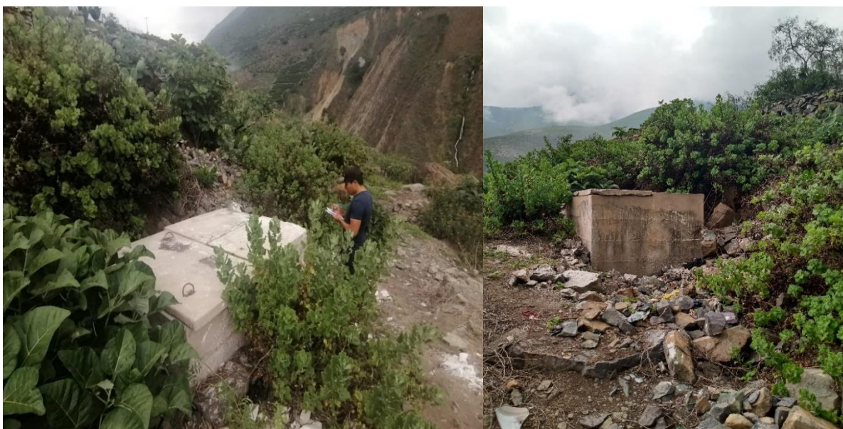
Figura 36. Evaluación de la Cámara de Reunión Existente en la PTAR.
