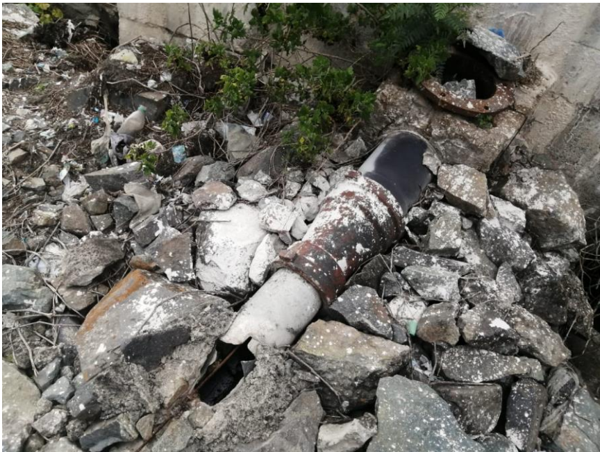
Figura 41. Vista de la Salida de Lodos del Tanque Imhoff hacia el lecho de secado, Inoperativo.
