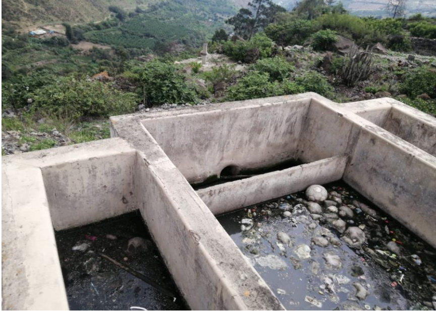
Figura 40. Vista del Interior se encuentra Colapsada con Basuras del Tanque Imhoff .
