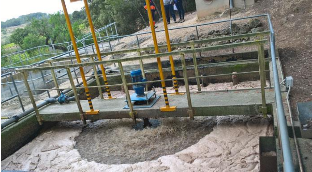
Figura 4. Reactor biológico con flotantes
