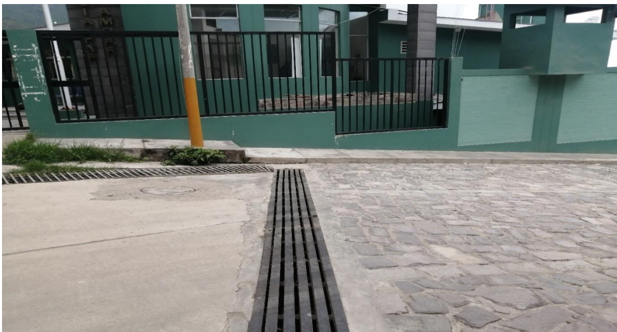
Figura 25. Canaleta se ubica en de la calle San Martín, estas son descargadas en una quebrada Ulunte ubicada en la entrada que luego termina al río Ámbar.
