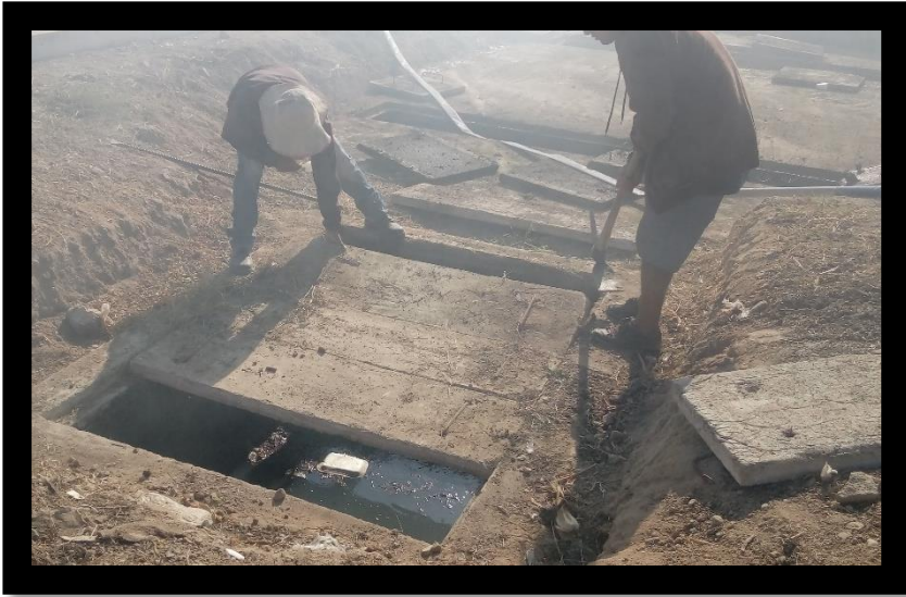
Figura N°17: Apertura de la cámara de rejas
