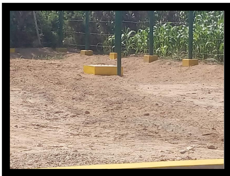
Figura N°24: Tapa de pozos percoladores
