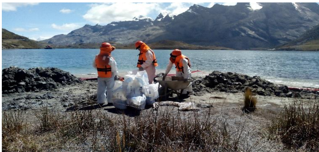
Figura 11a. Actividades de limpieza y preparación del terreno Fuente: galería fotográfica de la empresa
