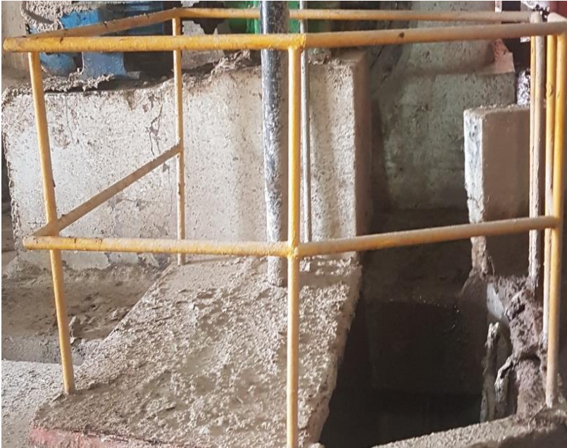
Figura 10. Poza intermedia de la planta de tratamiento de PANASA – Paramonga.
