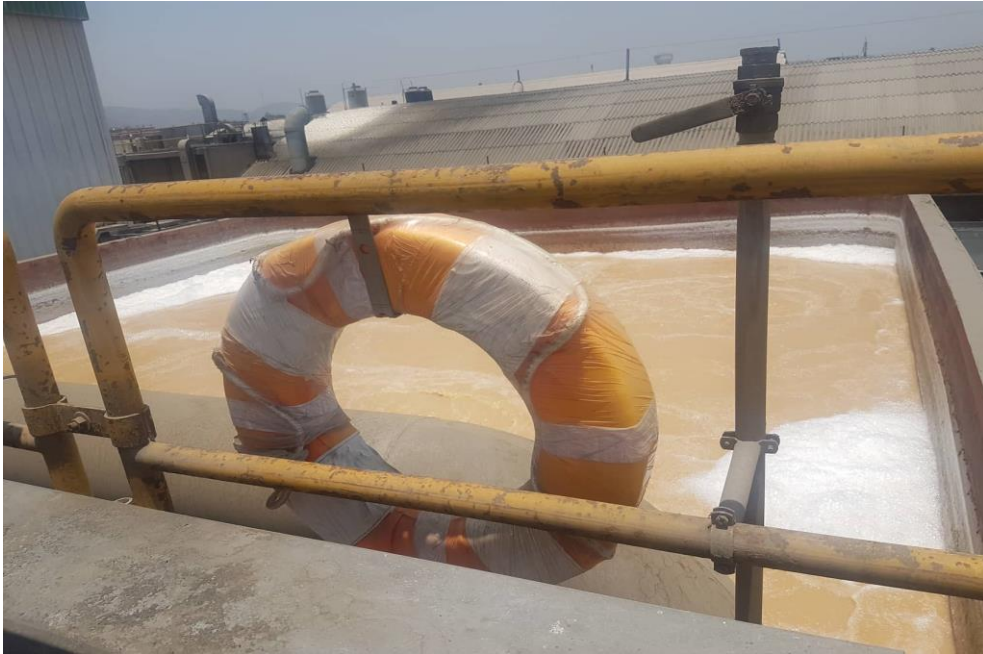
Figura 35. Parte Superior de la PTAR.
