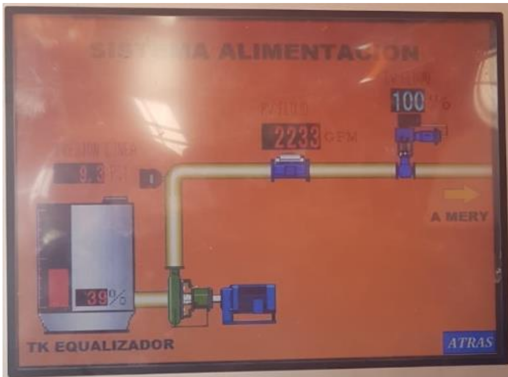
Figura 17. Control automático de alimentación al tanque de flotación Daf-Meri.
