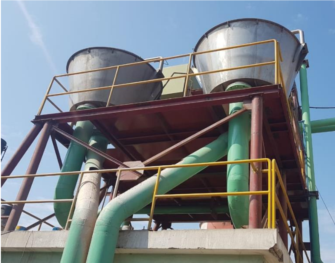
Figura 25. Vista de los dos filtros Rotoflex.
