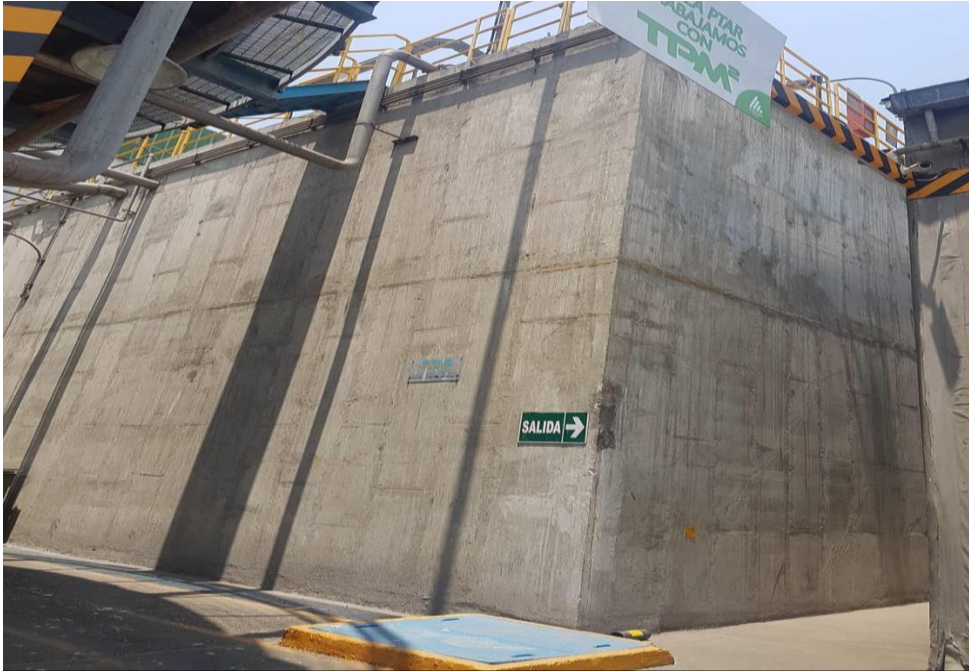
Figura 33. Parte inferior de la PTAR.
