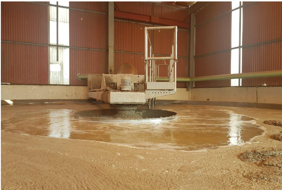
Figura 16. Material flotado en acumulación en el tanque de flotación Daf-Meri.
