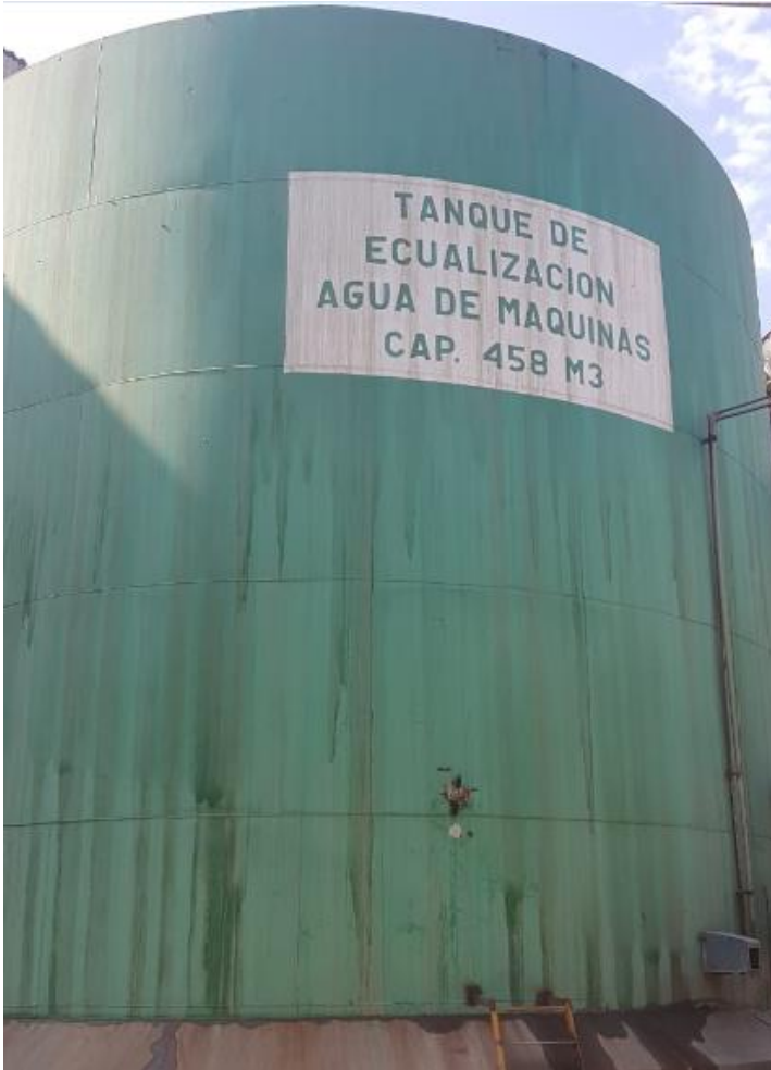
Figura 12. Tanque de ecualización de la planta de tratamiento PANASA – Paramonga.
