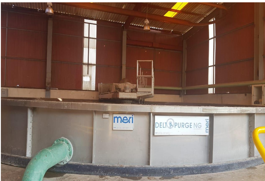
Figura 14. Vista frontal del tanque de flotación Daf-Meri.
