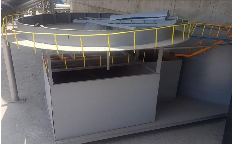
Figura 31. PTAR: Reactor biológico y DAF.
