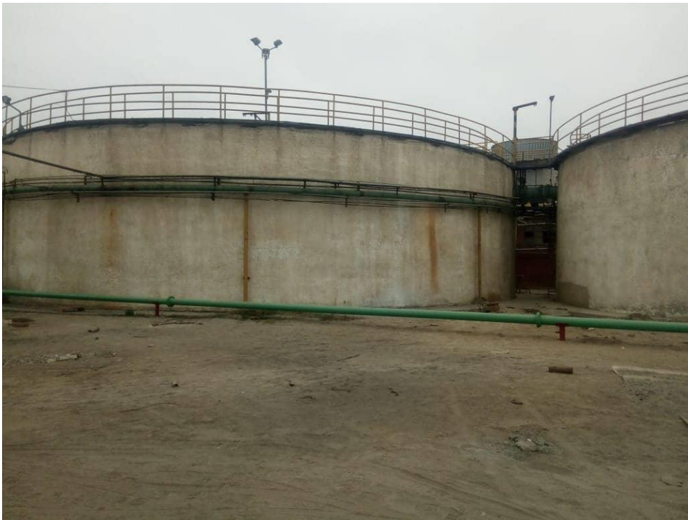
Figura 5. Tanque de tratamiento GRAVERS.
