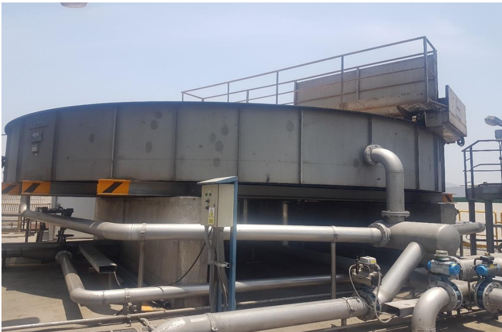
Figura 36. Tanque de flotación DAF.
