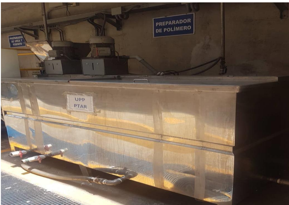
Figura 32. Tanque de preparación de polímeros.
