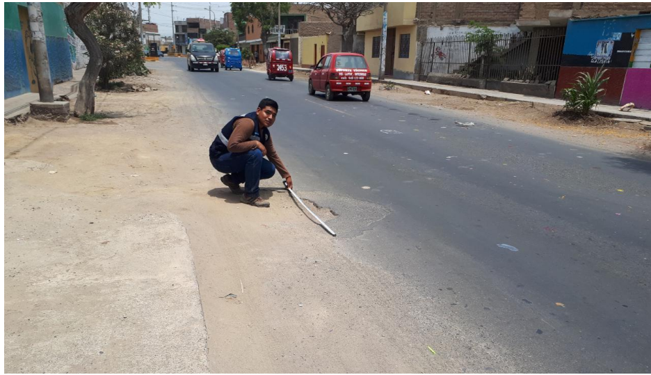
FOTO N° 02: INVESTIGADOR RECONOCIENDO LAS PRINCIPALES FALLAS DEL PAVIMENTO
