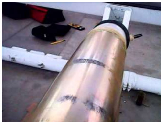
Figura 2 Corrosión por fricción.
