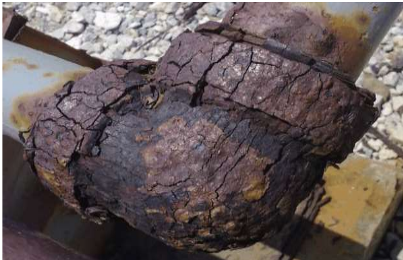
Figura 6 Corrosión por erosión.
