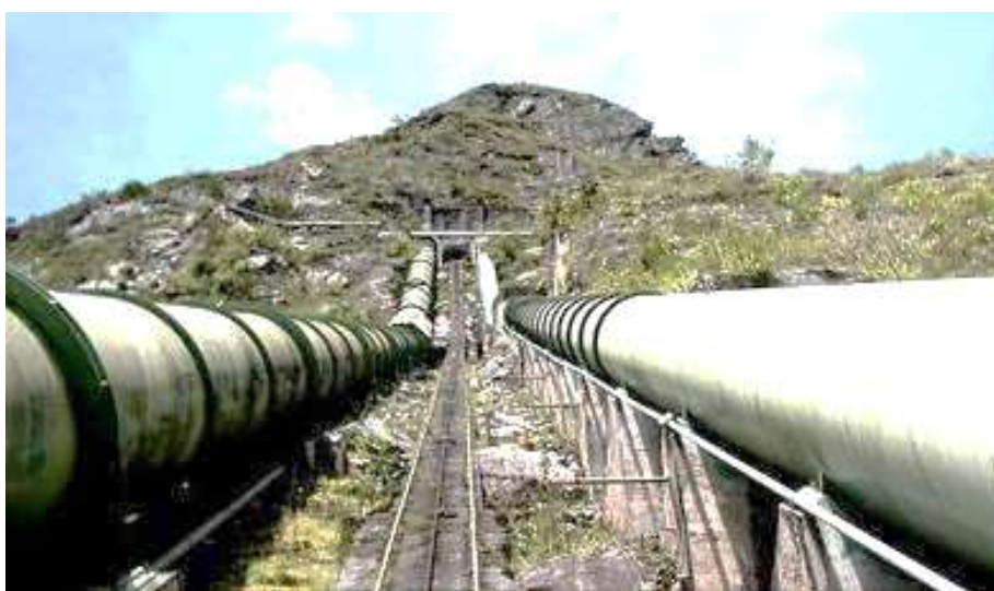
Figura 15 Tuberías de descarga de la C. H. Machupicchu.
