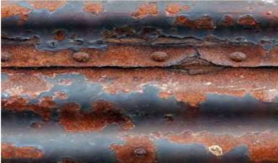
Figura 3 Corrosión en placas.
