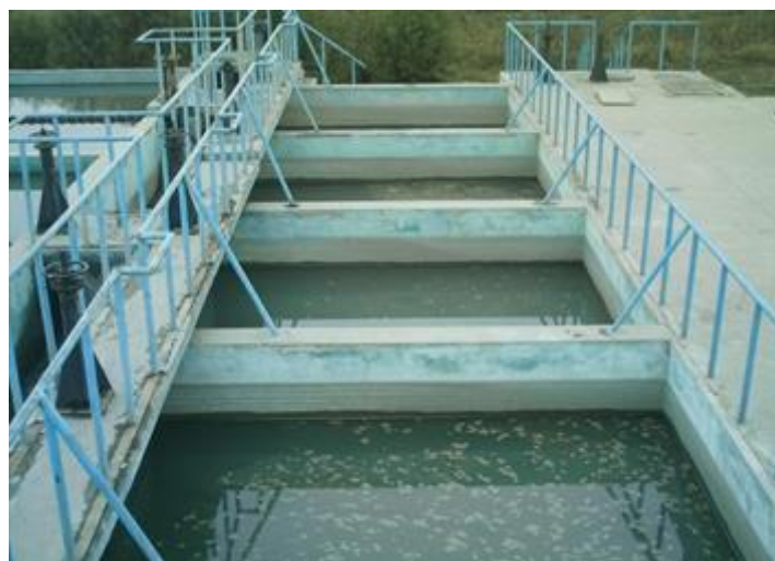
Figura 13. Batería de 4 Filtros
