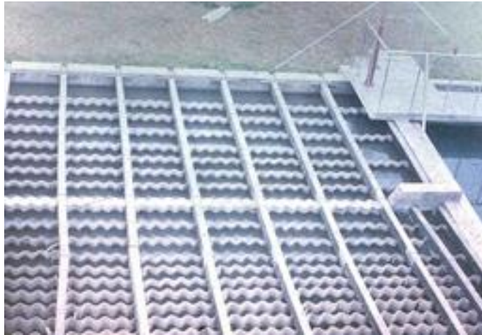
Figura 17. Floculadores de pantallas existentes
