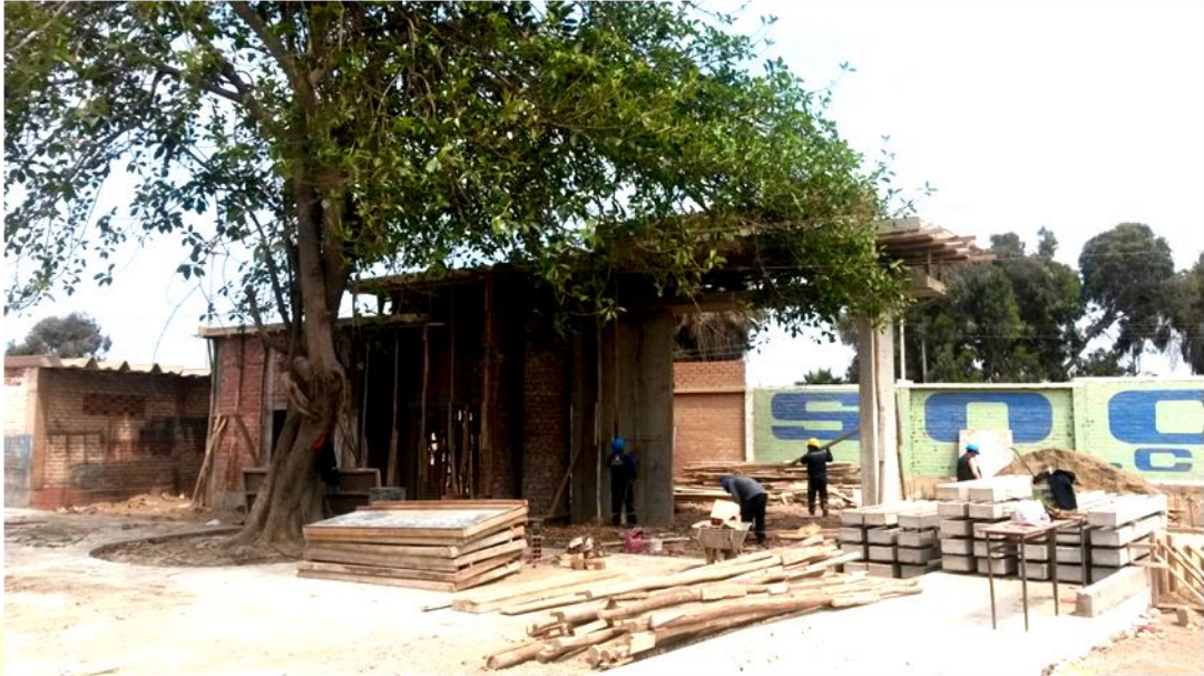
Foto N° 11. Vista fotográfica del desencofrado del ingreso N° 03 proyectado y encofrado de sobrecimiento armado del cerco tipo UNI
