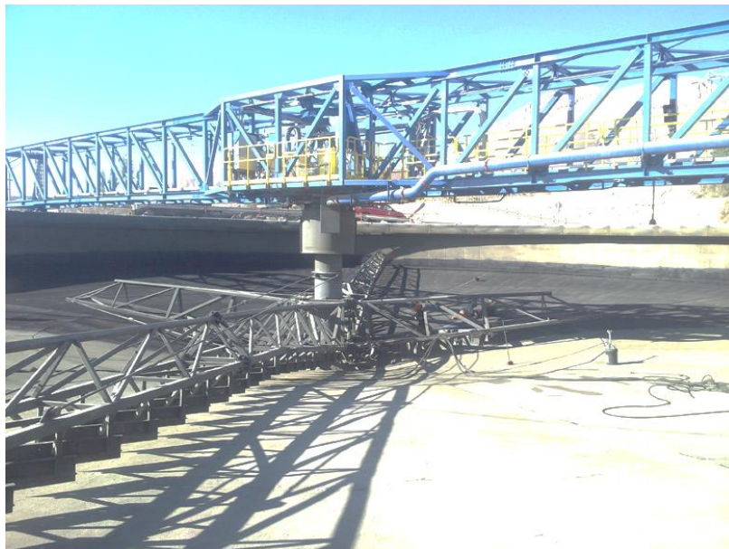
Figura 6. Estructura de soporte tipo puente.
