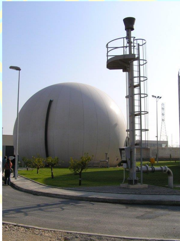
Ilustración 56: Depósito de acumulación del biogás (gasómetro) y antorcha de quemado. Imagen tomada de: http://usuarios.arsystel.com/raulh/edar_pinedo/1250.jpg
