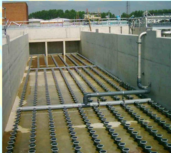
Ilustración 32: Difusores de un reactor biológico de lodos activados. Imagen tomada de: http://www.brightwaterfli.com/files/20050331052309_Aeration-001.jpg
