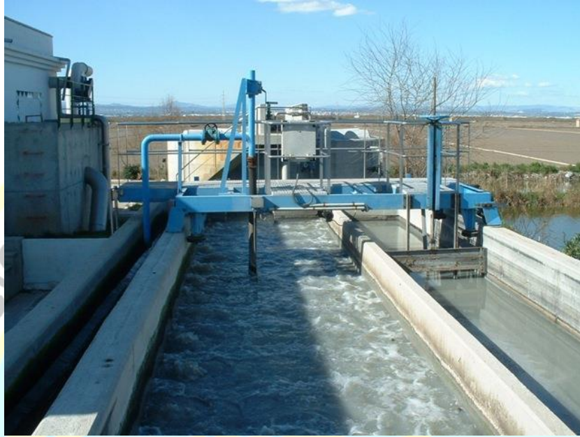
Ilustración 17: Desarenador-desengrasador. Imagen tomada de: http://www.vlcc ciudad.com/las-depuradoras-generan-679-toneladas-de-fangos/
