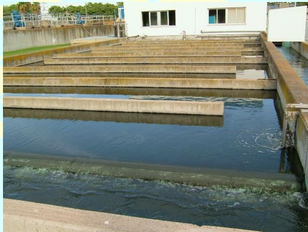
Ilustración 60: Canal de contacto para desinfección de aguas residuales tratadas.
