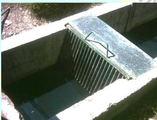
Ilustración 11: Rejilla media con lámina perforada para escurrimiento del material extraído. Foto: William Antonio Lozano-Rivas.
