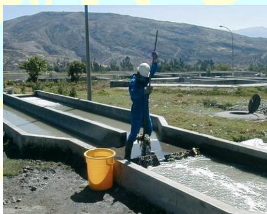
Ilustración 12: Operario retirando manualmente los sólidos retenidos en la rejilla. No cuenta con una canastilla o lámina de escurrimiento. Imagen tomada de: http://www.huber.de/typo3temp/pics/84ea1074e6.jpg?PHPSESSID=9e770a877a3fbf5149553f1525633a7d
