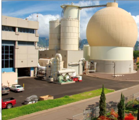
Ilustración 29: Tratamiento de lodos de una depuradora. Imagen tomada de: http://www.hawaiireporter.com/wpcontent/uploads/2011/08/Screen-shot-2011-08-02-at-7.36.03-AM.png
