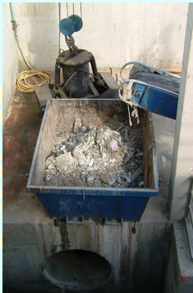
Ilustración 9: Contenedor para el depósito del material extraído del pozo de muy gruesos. Al fondo, cuchara bivalva. Imagen tomada de: http://prueba2.aguapedia.org/master/formacion/edar/temario/obrallegada/17.jpg
