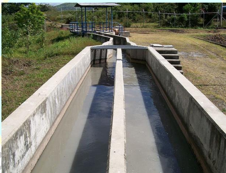
Ilustración 16: Canales desarenadores. Imagen tomada de: http://www.flickr.com/photos/gepadi/2109061728/in/photostream/
