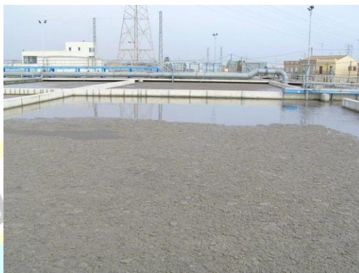
Ilustración 62: Zona anóxica para desnitrificación. Imagen tomada de: http://usuarios.arsystel.com/raulh/edar_pinedo/1207.jpg
