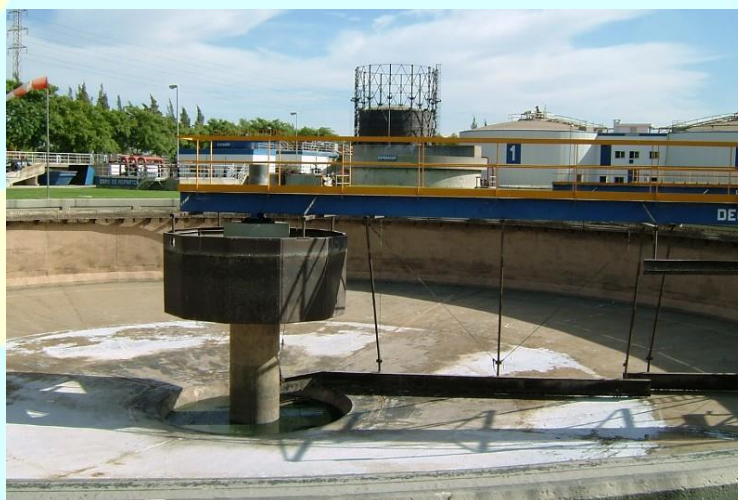
Ilustración 25: Decantador vacío. Se aprecia la campana deflectora, la poceta de fangos, el puente móvil con las rasquetas (barredor de fangos) y el desnatador (barredor de grasa).
