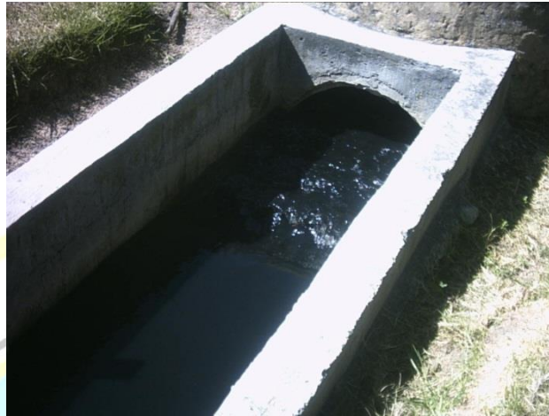
Ilustración 6: Canal de ingreso a una PTAR. Foto: William Antonio Lozano-Rivas.
