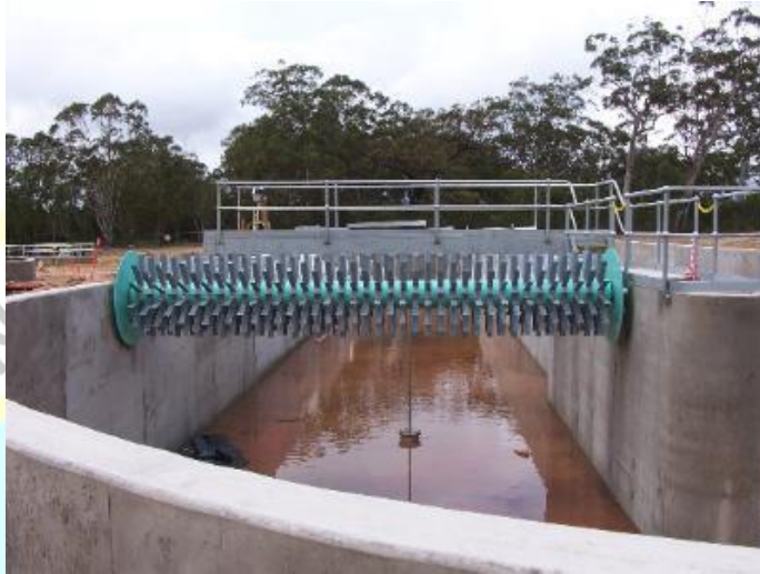
Ilustración 37: Cepillo de aireación en un zanjón de oxidación. Imagen tomada de: http://www.cstwastewater.com/upload/images/CoolahShire_BrushAerators.jpg
