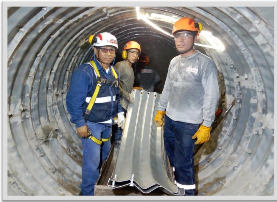
Fuente: ENEL DISTRIBUCION PERU S.A.A.-PERFORACIONES PERU SAC-2018
