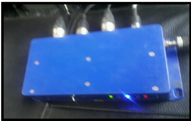
Figura 20- Módulo de Interfaz instalado
