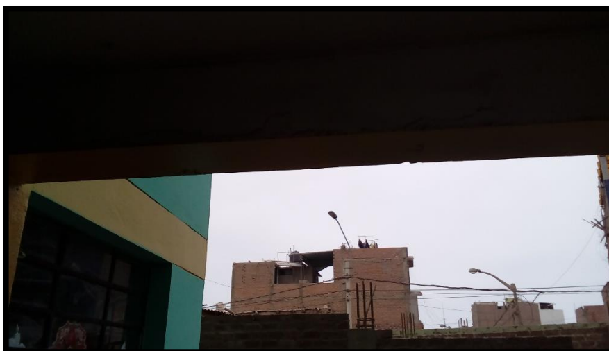
Figura N° 65: Bloque C – Presencia de fisuras y Grietas en la viga parte interna
