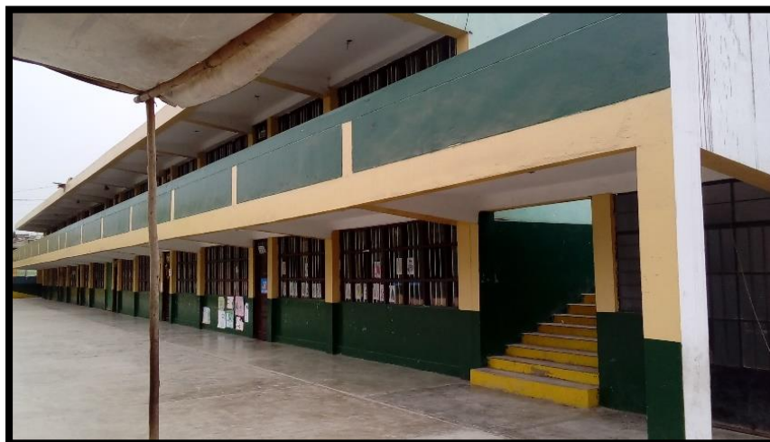
Figura N° 42: Bloque A – Presencia de columnas de confinamiento de parapetos
