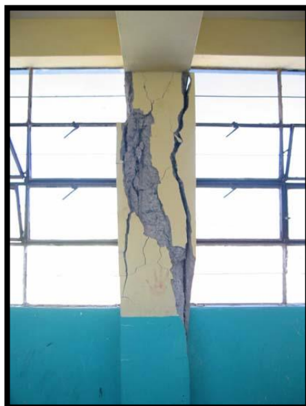
Figura N° 9: Falla por columna corta Fuente: (Google, El terremoto, 2001)
