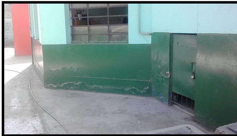
Figura N° 59 Afloramiento de humedad en los sobrecimientos.
