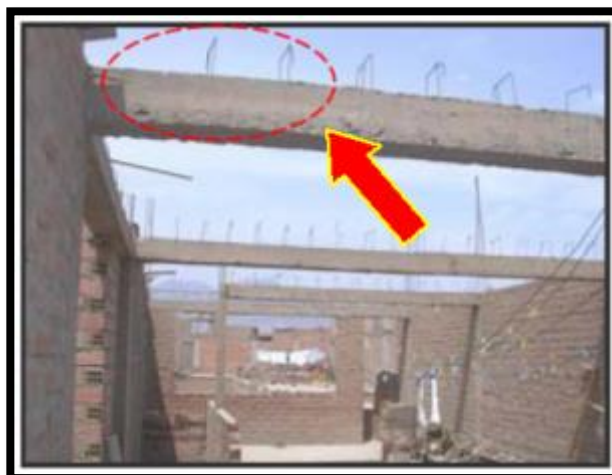
Figura N° 17 : Ejemplo de proceso constructivo deficiente: Viga vaciada en dos partes Fuente: (Ingenieros.com, s.f.)
