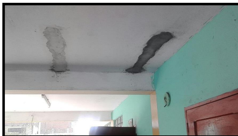
Figura N° 61: Resanes en los techos.
