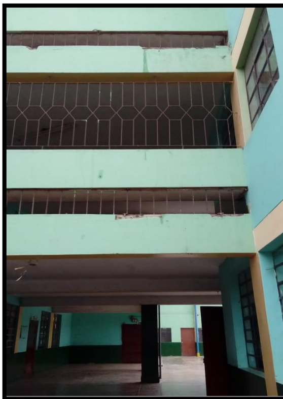
Figura N° 66: Bloque C– Presencia de fisuras y Grietas en la viga parte interna.
