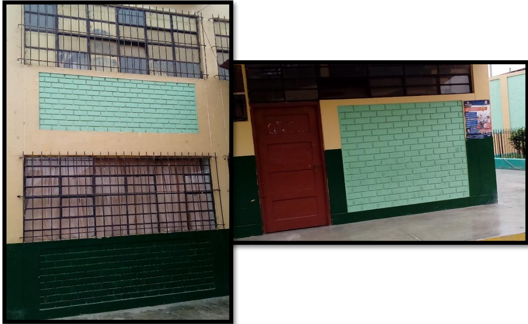
Figura N° 50: Bloque B – Separación de alfeizar de ventanas de pórticos principales
