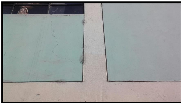
Figura N° 60: Fisuras en muros.
