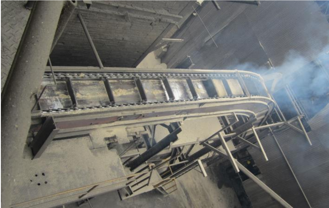
Figura 17. Conductor de bagazo principal del trapiche
