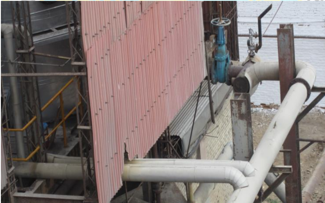
Figura 41. Vista general estación principal de reducción de presión
