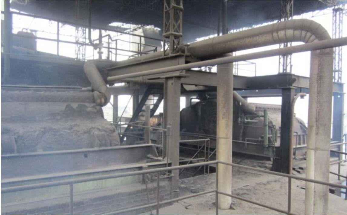
Figura 30. Tubería de vapor de las calderas al colector principal
