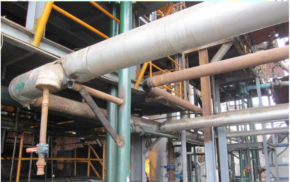
Figura 45. Tubería de vapor a los calentadores de Jugo encalado.
