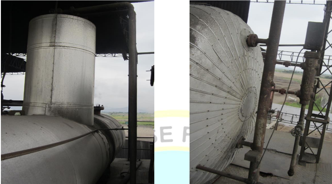
Figura 15. Torre de reevaporizado y controlador de nivel del desaereador
