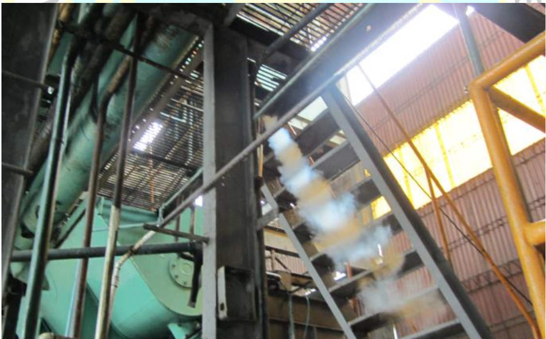
Figura 49. Fuga tubería de vapor al tacho.
