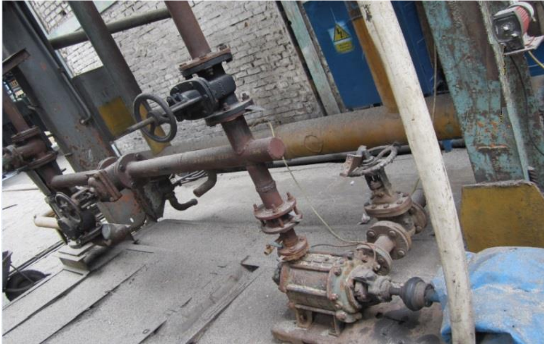
Figura 9. Sistema de bombeo 3 de agua condensada a calderas
