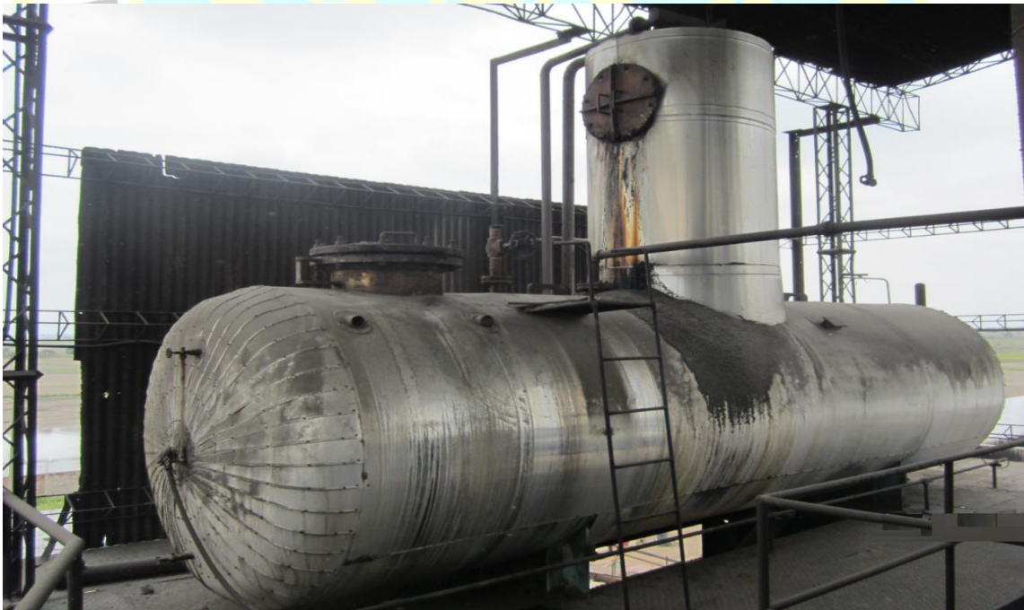
Figura 14. Falta de reúso de reevaporizados al tanque desaerador
