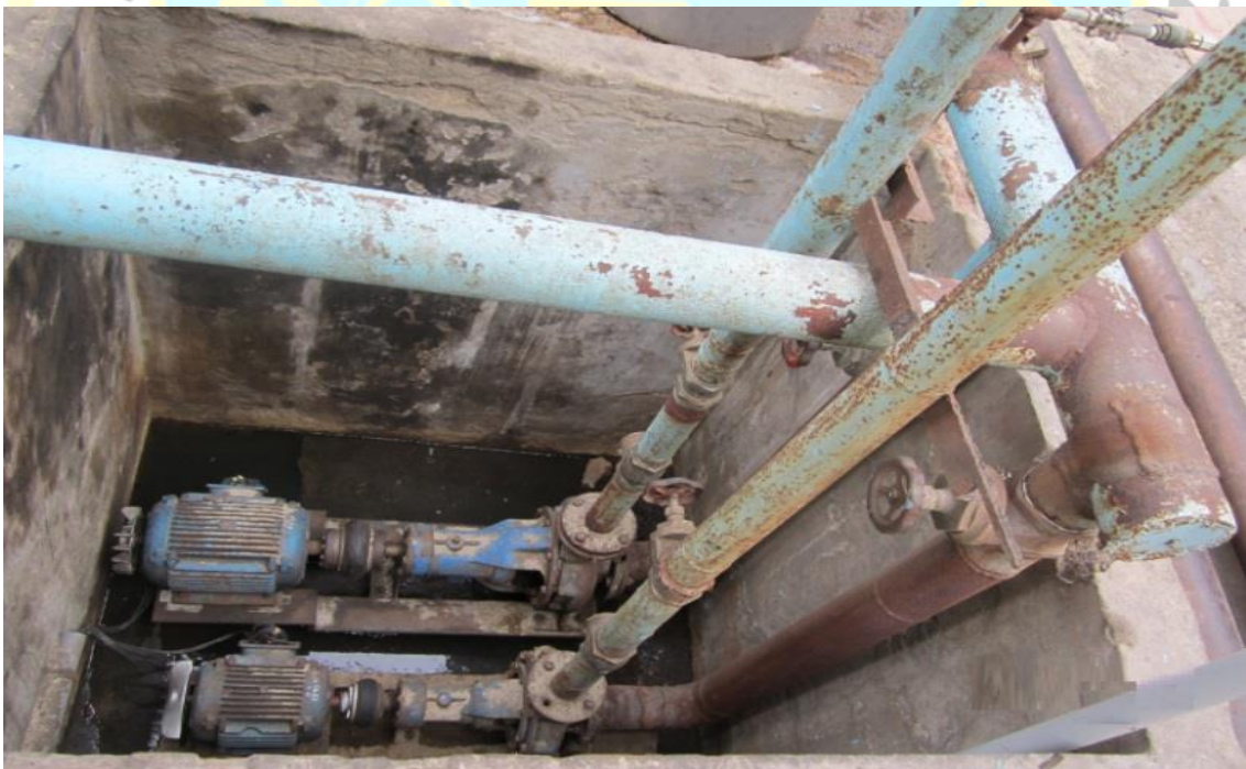
Figura 8. Sistema de bombeo 2 de agua condensada al desaereador
