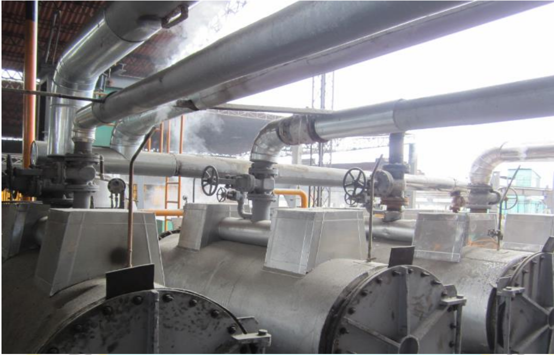
Figura 46. Tubería de vapor ingreso a los calentadores de jugo encalado.
