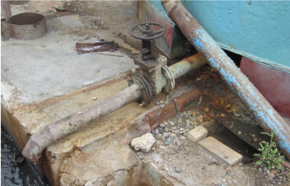
Figura 6. Fugas de agua condensada en el tanque de almacenamiento 5.
