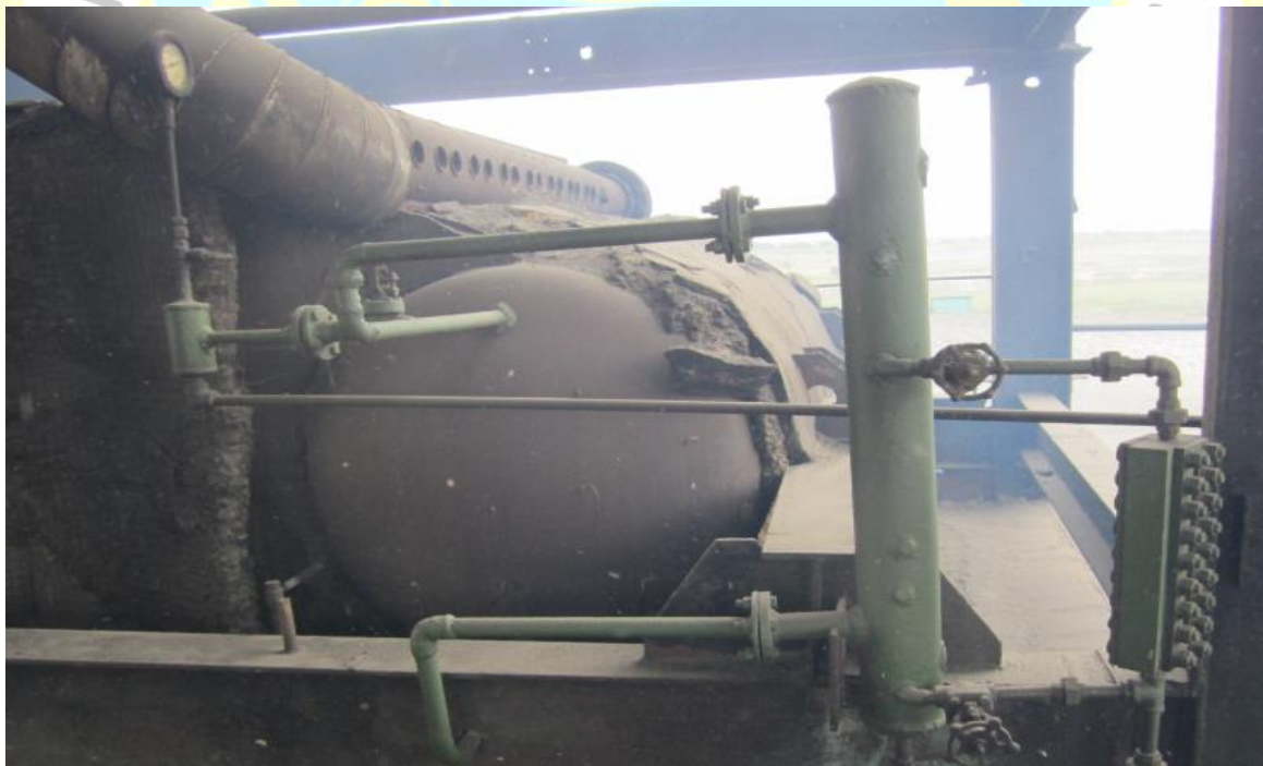
Figura 38. Indicador de nivel del caldero 2
