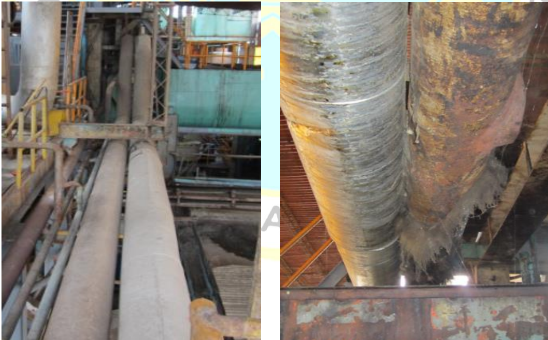
Figura 47. Tubería de vapor a los tachos.
