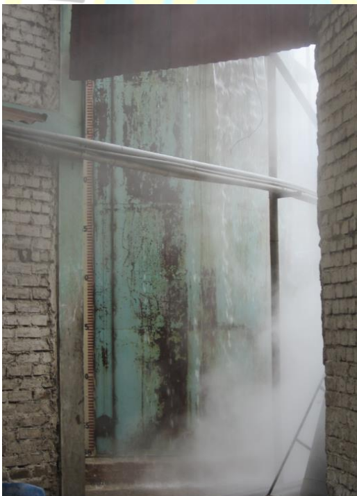
Derrame del tanque vertical
