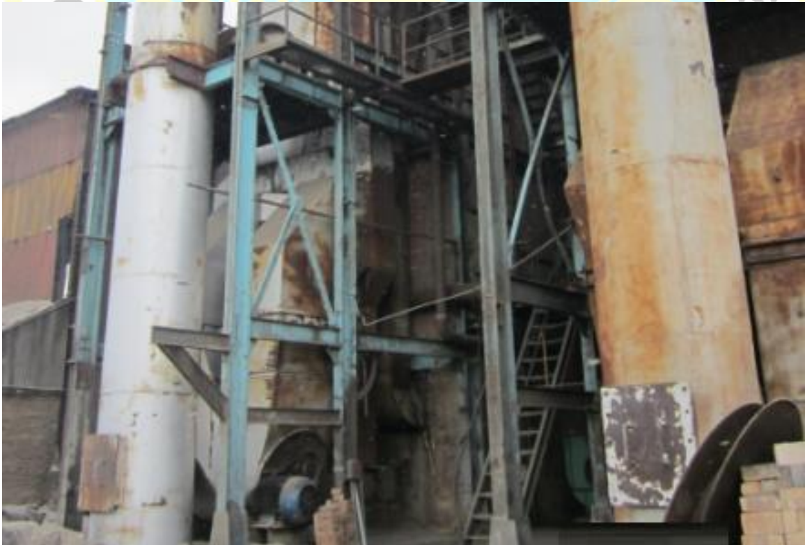
Figura 27. Chimeneas y ventiladores inducidos de caldero 1 y 2
