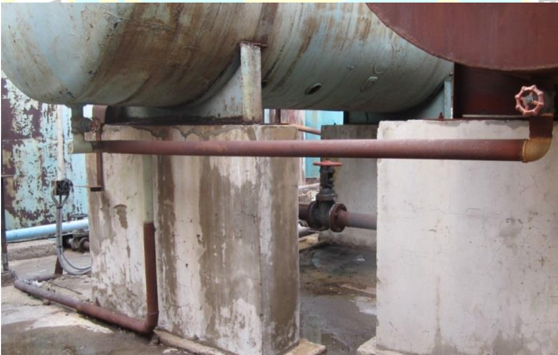
Figura 10. Tuberías de agua condensada sin aislar al desaereador
