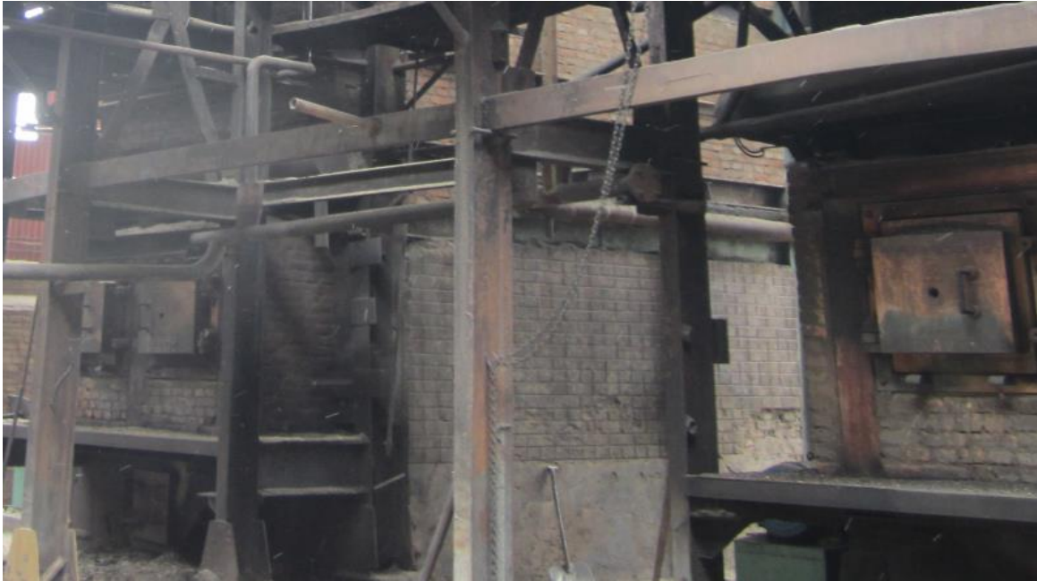
Figura 39. Compuertas de inspección y limpieza de los calderos 1 y 2
