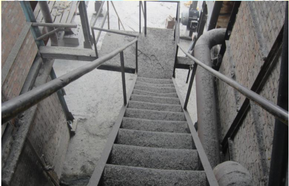
Figura 24. Conducto de aire alimentado al hogar de la caldera 2
