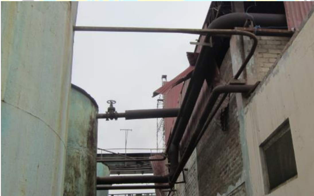
Figura 56. Tuberías de retorno de condensados sin aislamiento
