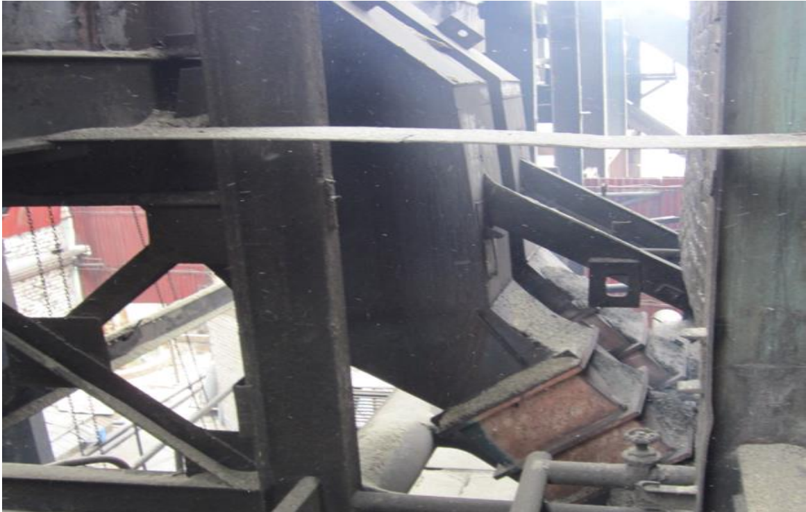
Figura 19. Chute de alimentación de bagazo a las calderas
