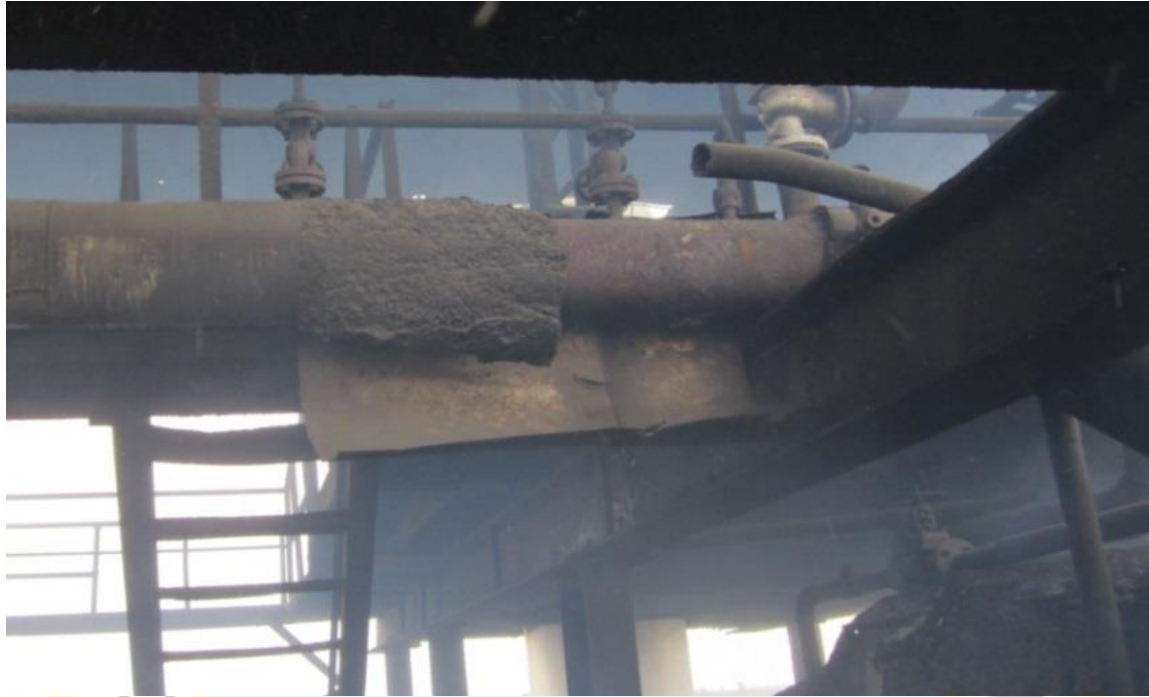
Figura 28. Salida de vapor del domo de la caldera 1.
