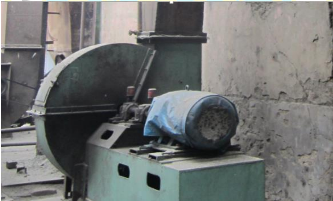
Figura 22. Ventilador de tiro forzado de aire de alimentación al hogar de la caldera 1
