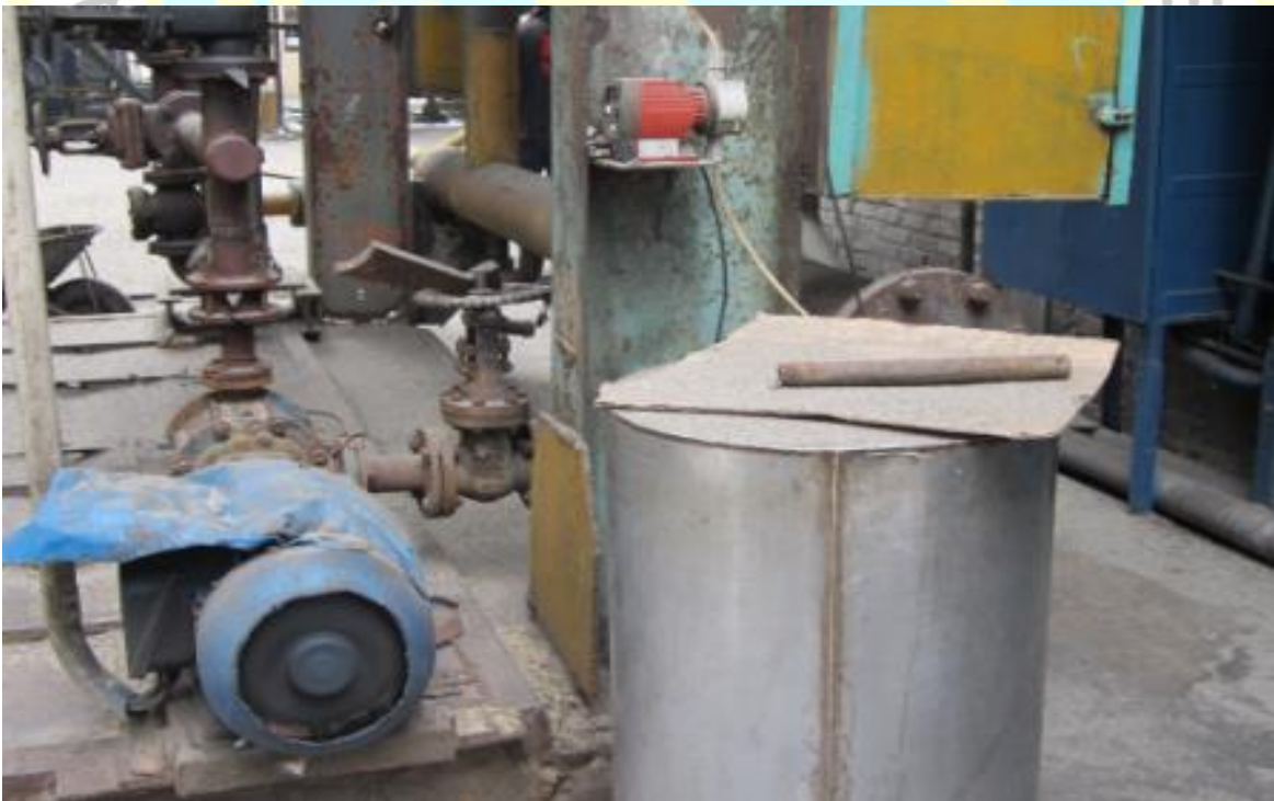
Figura 12. Dosificación de aditivos a las calderas
