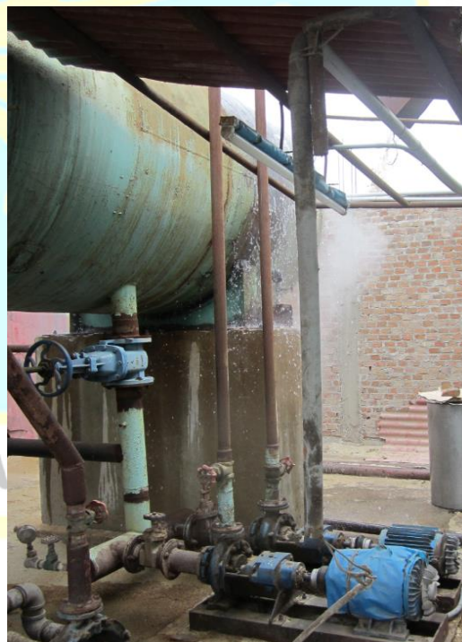
Derrame del tanque horizontal
