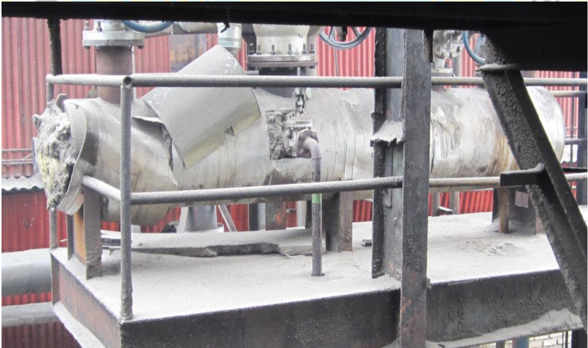
Figura 33. Estado del colector principal de vapor.
