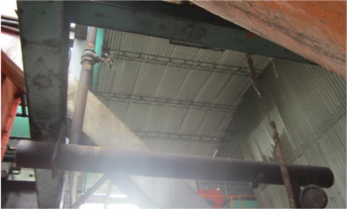
Figura 48. Tubería de vapor al secador.
