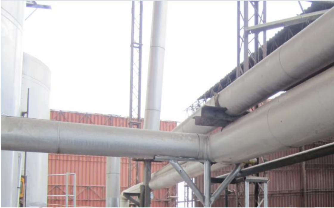
Figura 44. Tubería de vapor a Vacumpanes y calentadores.
