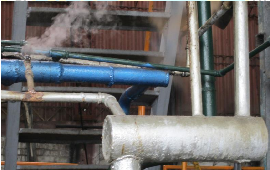
Figura 51. Fuga de vapor área centrifuga
