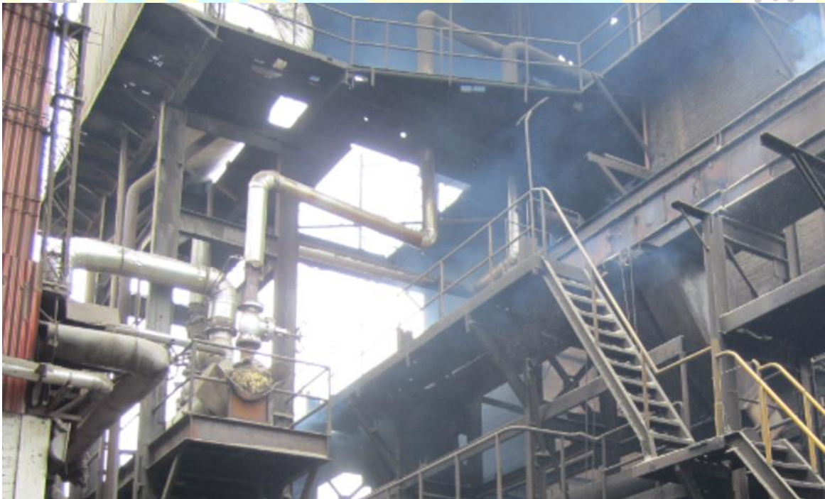
Figura 31. Tuberías de vapor de salida de los calderos 1 y 2
