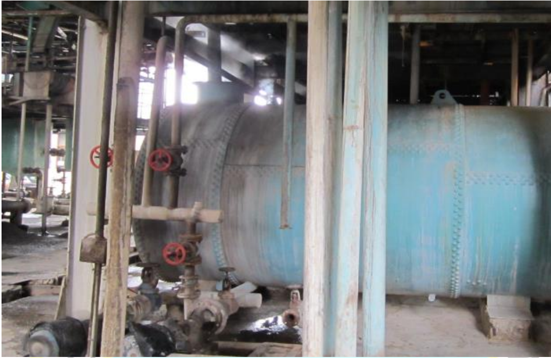
Figura 55. Tanque de agua condensada uso fabrica 1
