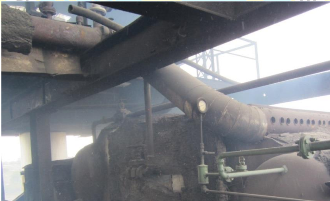
Figura 29. Salida de vapor del domo de la caldera 2.
