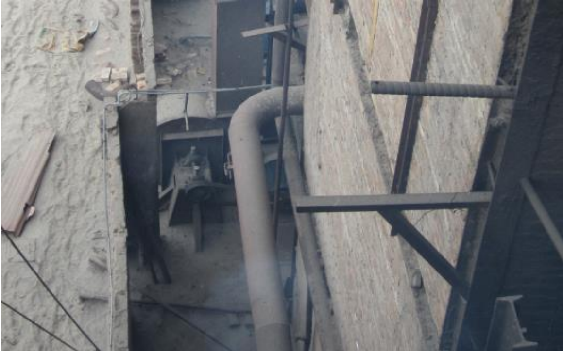
Figura 23. Conducto de aire alimentado al hogar de la caldera 1
