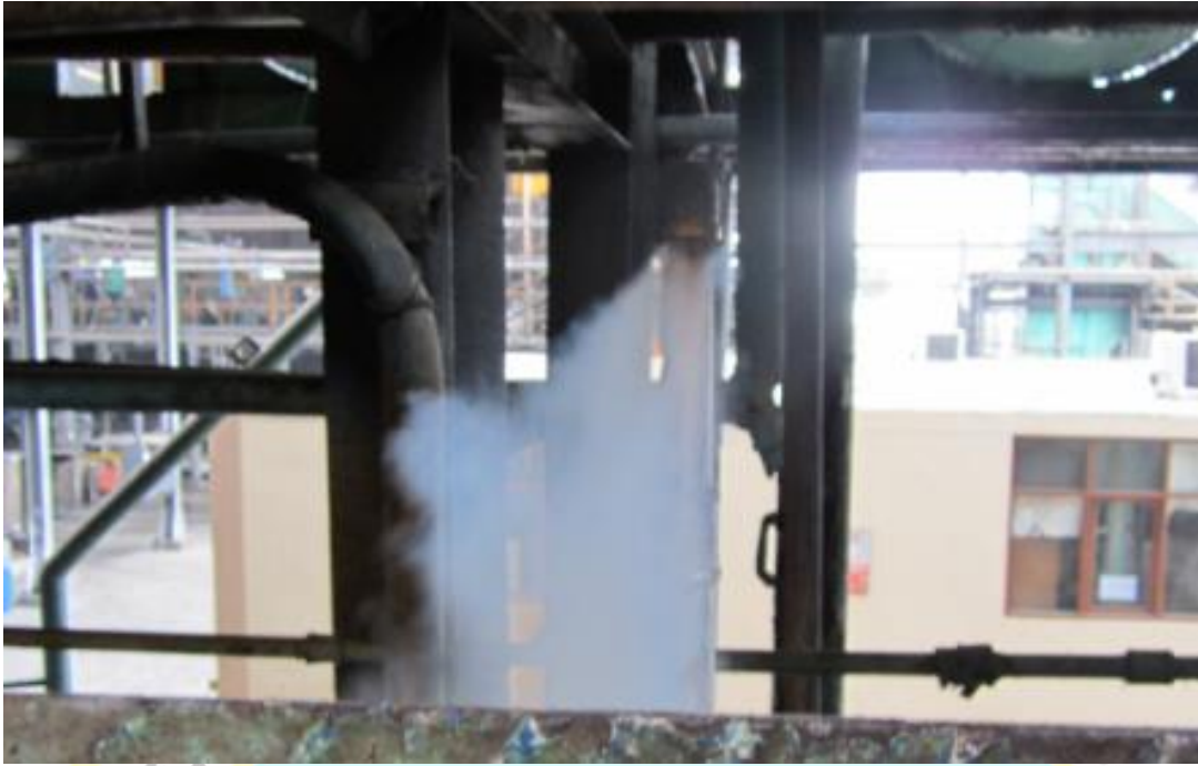
Figura 50. Fuga de vapor área de cristalización.
