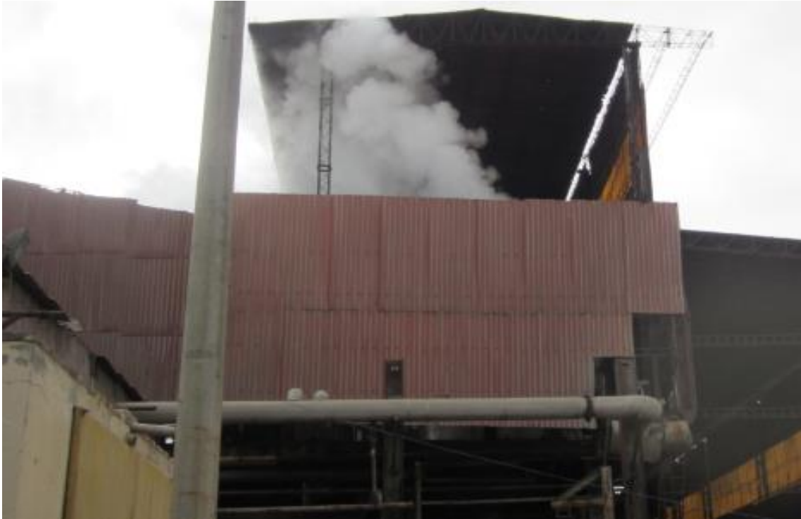
Figura 40. Fugas de vapor en las líneas por exceso de presión
