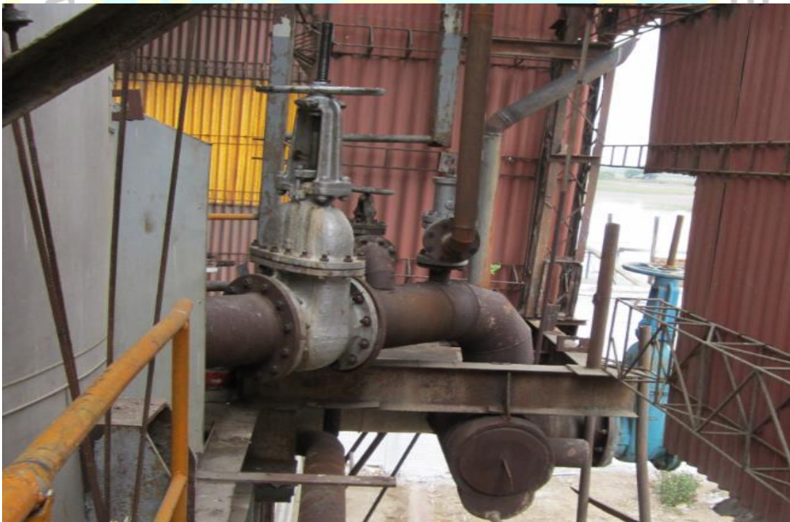
Figura 43. Vista lateral entrada de vapor al evaporador
