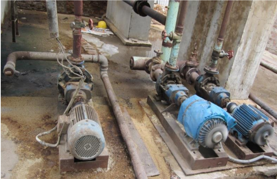
Figura 7. Sistema de bombeo 1 de agua condensada al desaereador
