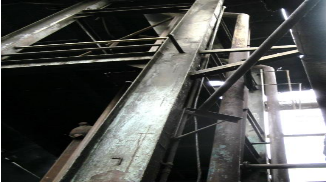
Figura 13. Tubería de agua de alimentación sin aislar a las calderas
