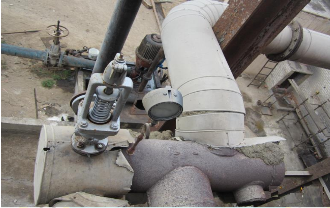
Figura 42. Detalle de la estación principal de reducción de presión
