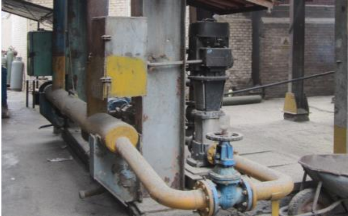
Figura 11. Tuberías de agua condensada sin aislar al caldero
