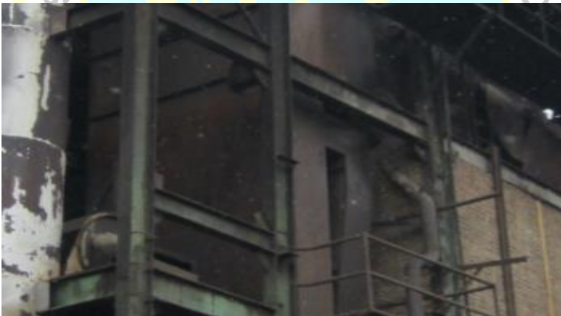
Figura 16. Economizador de la caldera
