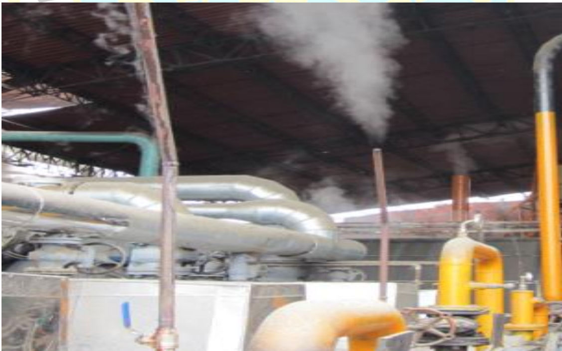
Figura 52. Pérdida de vapor en la evacuación de gases incondensables.
