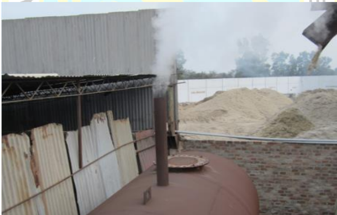
Figura 3. Pérdida de energía por reevaporizado en el tanque de almacenamiento 6
