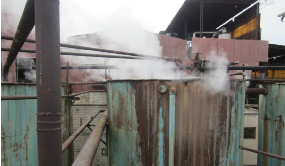
Figura 2. Vista parcial de pérdida de energía por reevaporizado en los tanques de almacenamiento 3, 4 y 5
