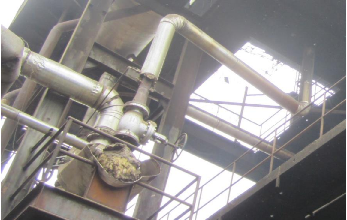
Figura 32. Tuberías de vapor de las calderas al colector principal de vapor
