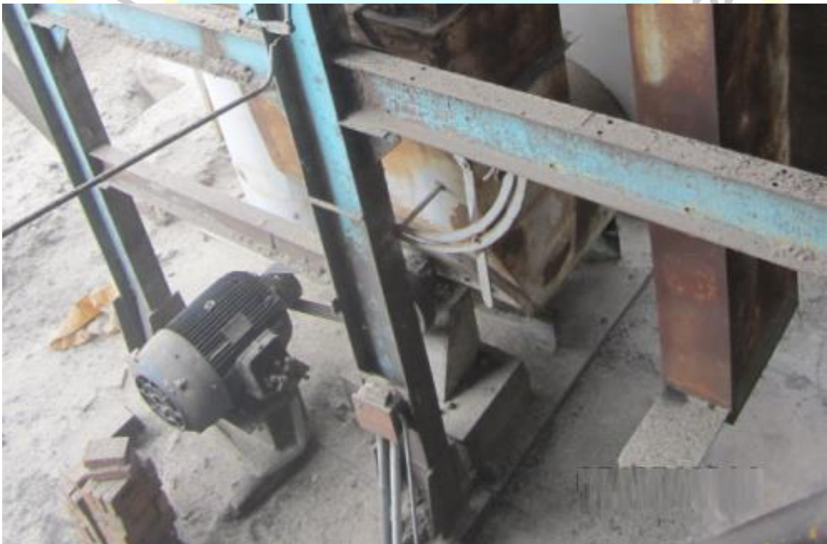
Figura 25. Ventilador de tiro inducido de la caldera 1
