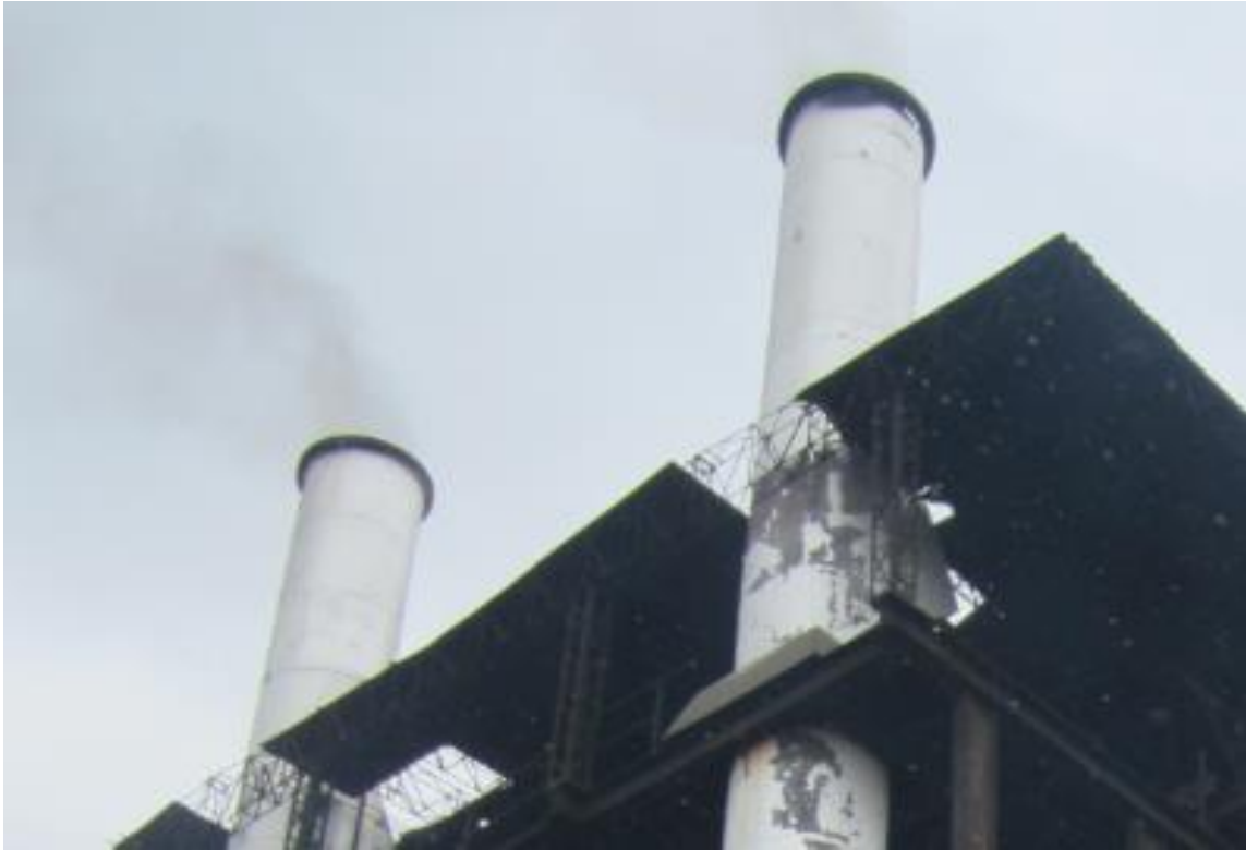
Figura 26. Emisiones gaseosas emitidas por las chimeneas de caldera 1 y 2
