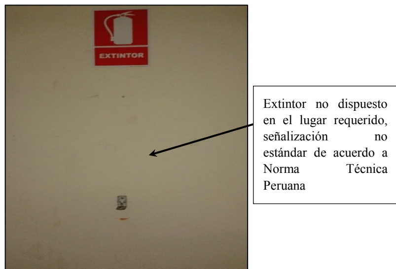
Figura 14. Respuesta a emergencia de amago de incendio deficiente.
